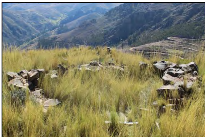
Estructura mediana de aparejo rústico y en mal de estado de conservación
