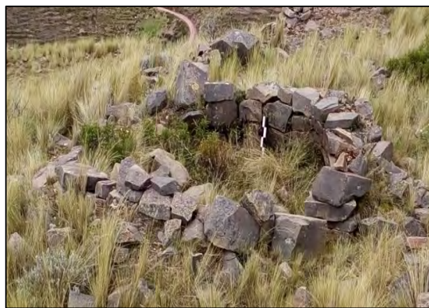
Nótese la pérdida de mortero en las juntas del muro de la estructura mediana N°51
