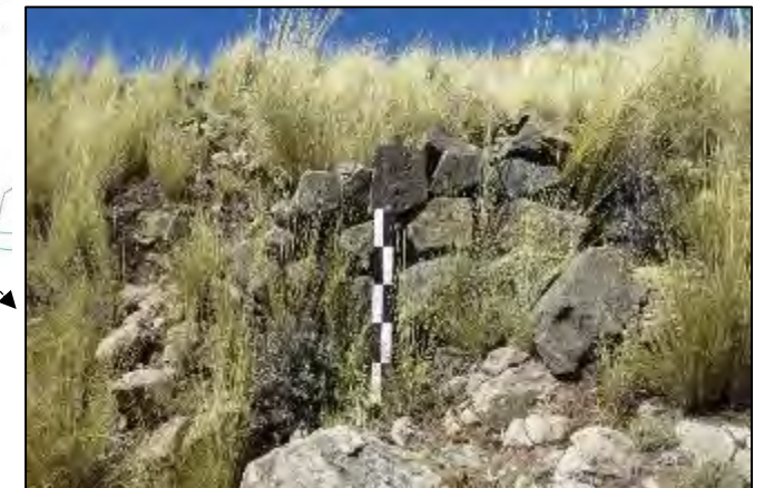
Muro de aparejo rústico en mal estado de conservación.
