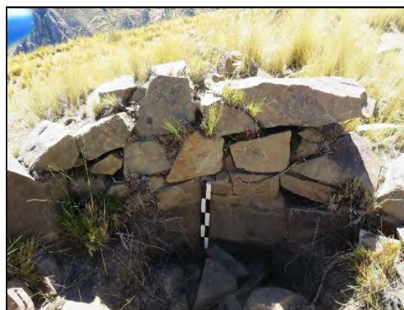
Paramento interno de la estructura mediana N°16, nótese la excavación clandestina
