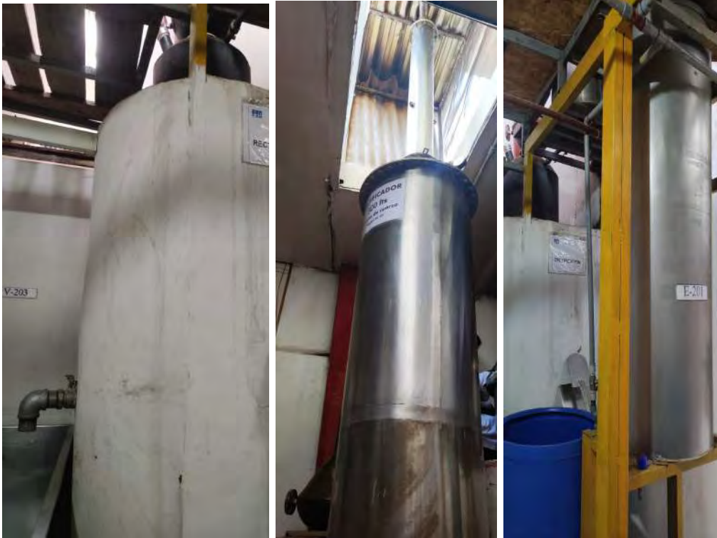
Figura 29: Equipo de rectificador de 300 litros. vista del calderín, vista de la columna de platos y rellenos, vista del sistema de enfriamiento
