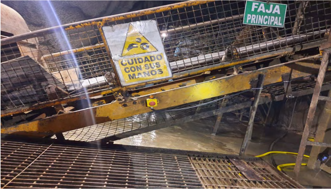
ANEXO 2: Imagen de planta shotcrete en interior mina Nv 14 automático
