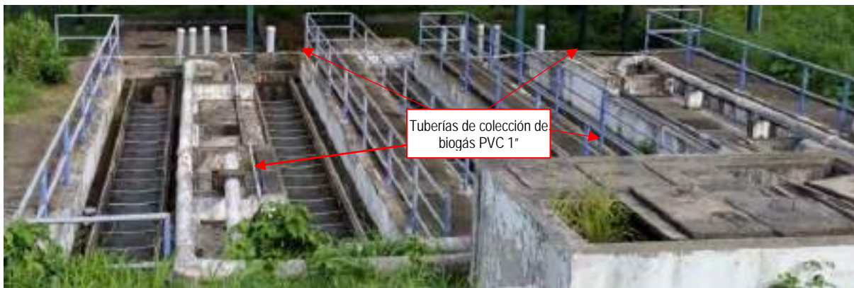
Tuberías de colección de biogás en reactor anaeróbico UASB-01
