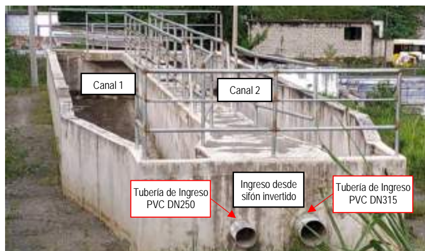
Desarenador en PTAR Chaquimayo
