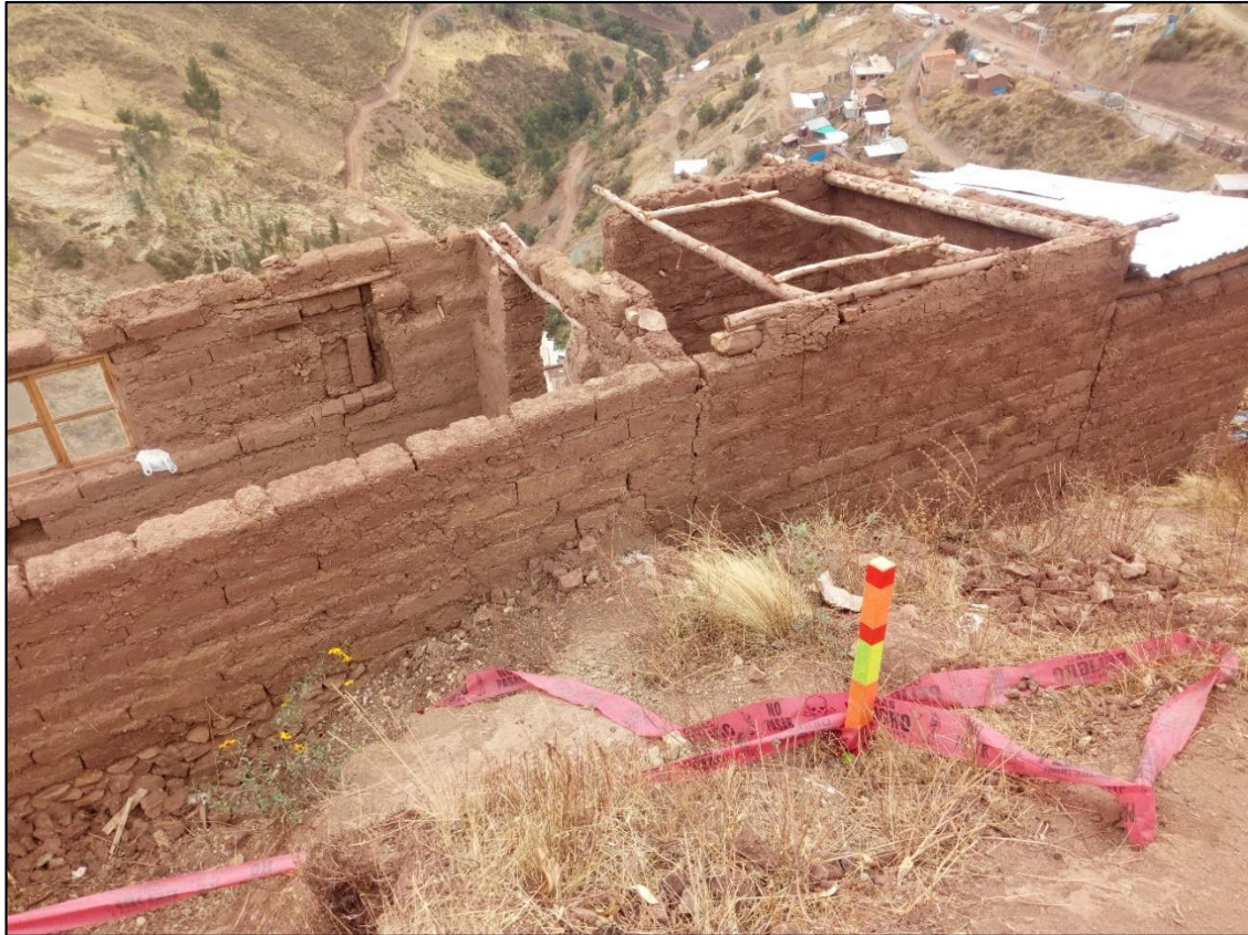
Fotografía 17. Deslizamiento delimitado con cinta de seguridad y desocupación del lote en la APV Hatunwasi.
