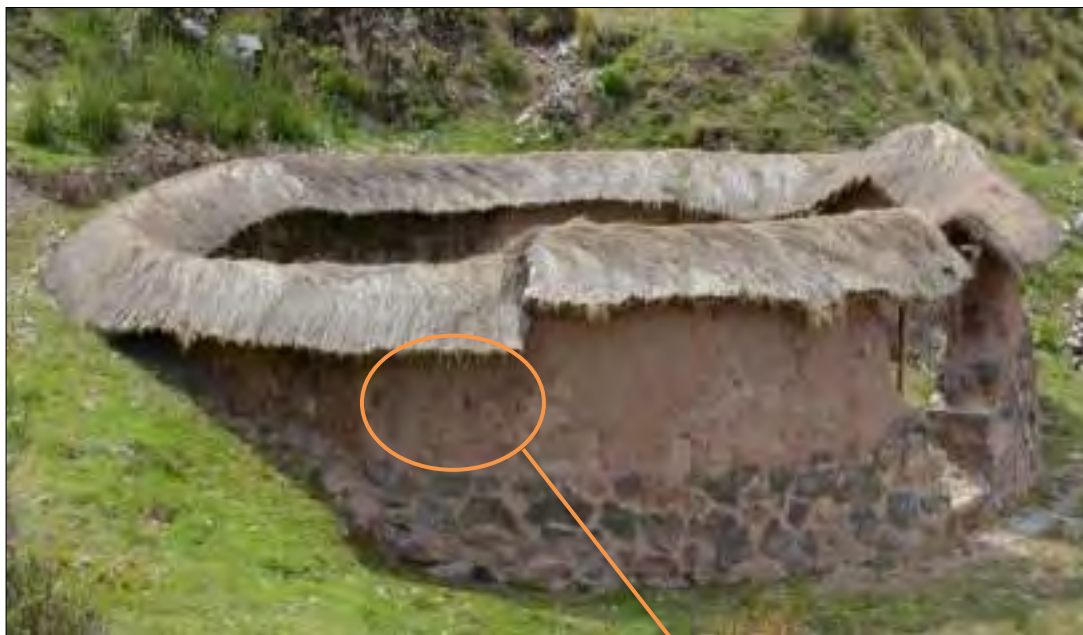
Imagen 44. En círculo naranja, sección de muro donde se evidencia enlucido original, nótese el enlucido contemporáneo a la derecha. Fuente: Propia
