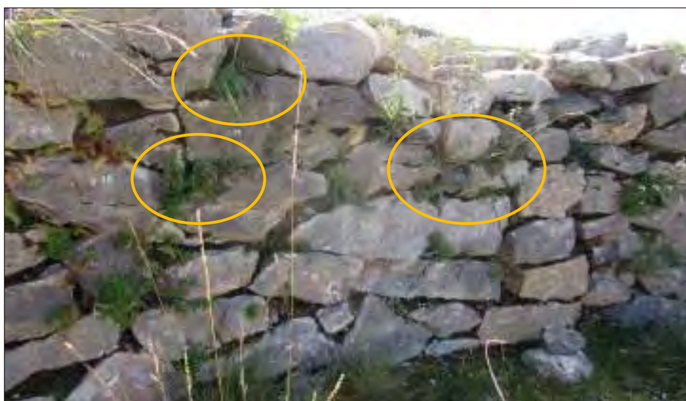
Imagen 23. Nótese la vegetación en las juntas de los muros. Fuente: Propia
