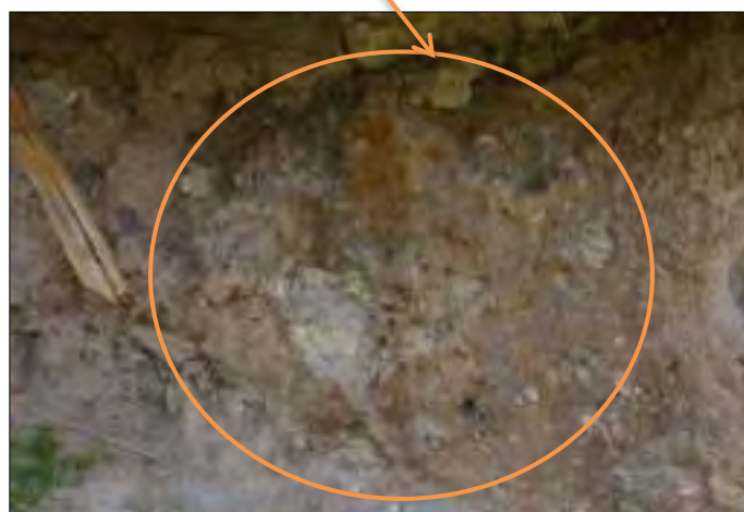
Imagen 45. Vista a detalle de restos de revoque original, nótese su alteración en color y forma. Fuente: Propia
