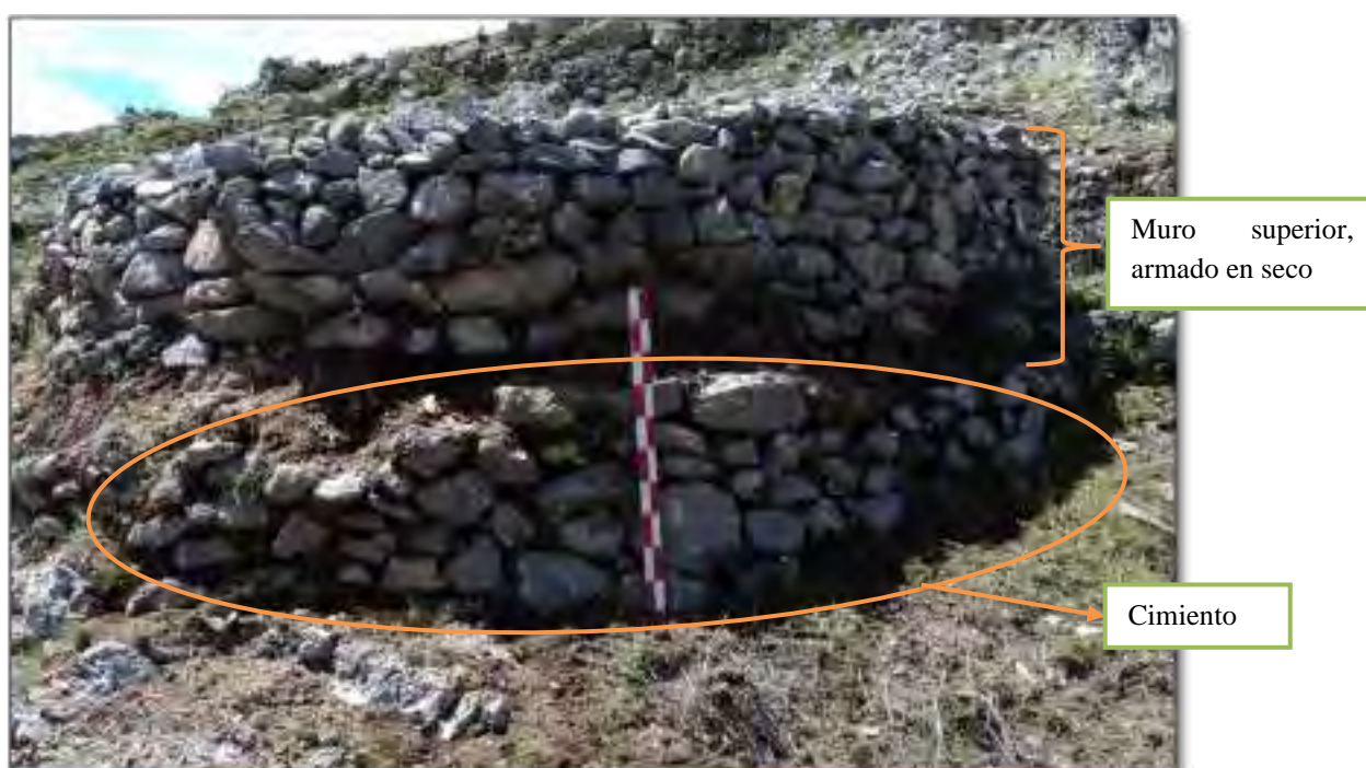
Imagen 27. Vista del lado este del recinto N° 47 en la que se puede apreciar el cimiento en comparación al muro superior. Fuente: Propia.
