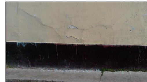
FIGURA 7: Exterior de Aulas – Rajaduras en paredes. Fuente: Propia, 2017
