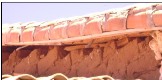
FIGURA 5: Estado actual de cubierta. Fuente: Propia, 2017
