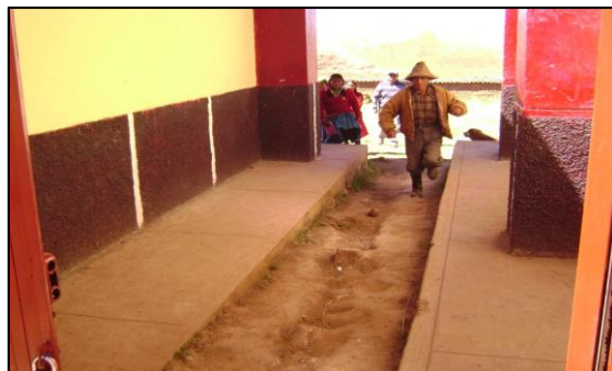
FIGURA 8: Exterior de Aulas – Rajaduras en paredes. Fuente: Propia, 2017
