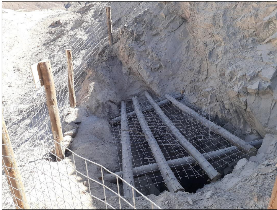
Figura 36. Chimenea de salida de caudal de aire zona Esperanza.
