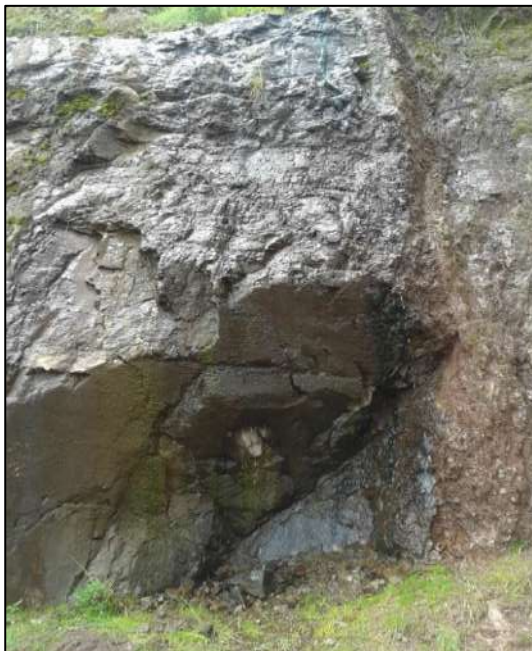
FOTOGRAFÍA 66: FILTRACION DE AGUA POR DISCONTINUIDADES Y/O FRACTURAS DEL MACIZO ROCOSO DE LA FORMACION ANTA.
