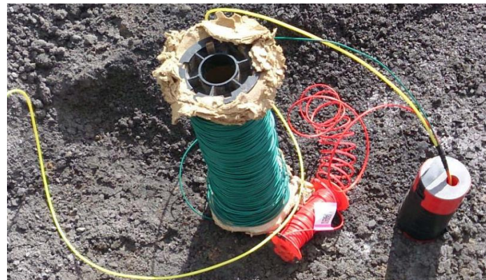
Figura 1.2. Instalación de cable resistivo junto al Booster y tubo de choque.
