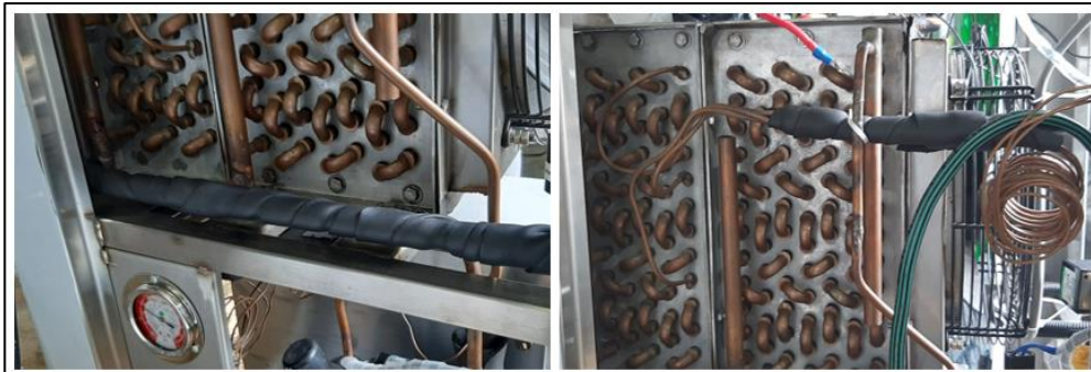
Figura 4-13 Aislamiento de tramos de tubería de cobre (línea de baja presión)
