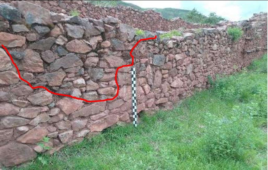
Se observa fisuras en el paramento norte de la kancha
