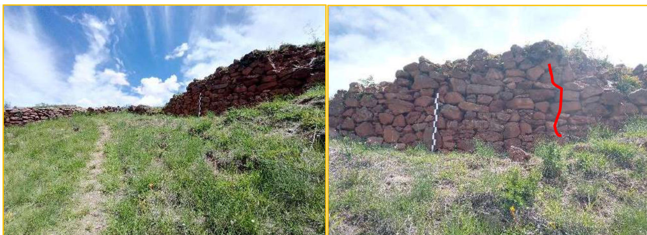
Figura 87 Fotografías del estado de conservación Kancha 75
