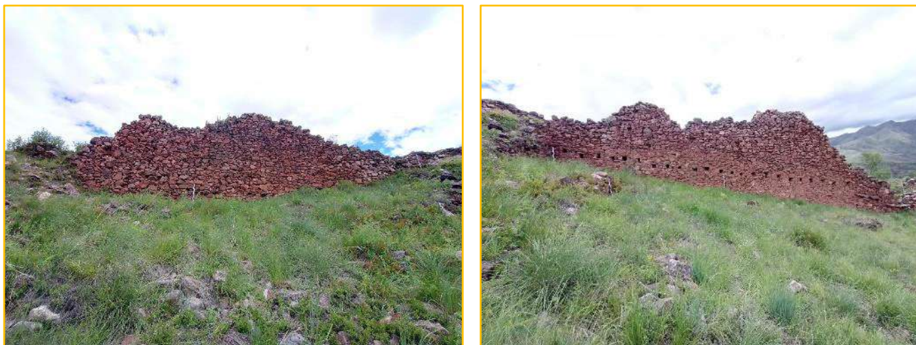
Figura 34 Fotografías del estado de conservación, Kancha 20.
