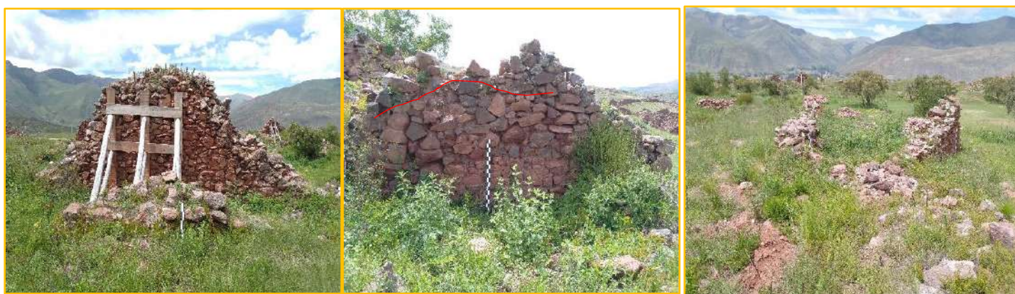
Figura 67 Fotografías del estado de conservación, Kancha 33
