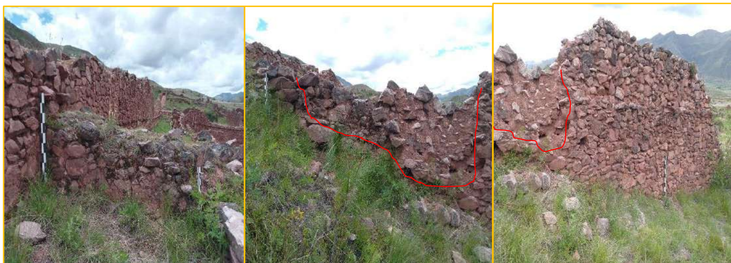
Figura 30 Fotografías del estado de conservación, Kancha 07.
