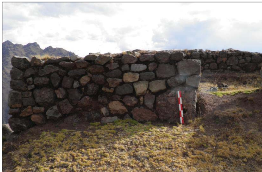
Foto N° 55: Muro en el Recinto 05. Fuente: (Rado Aguilar & Espinoza Cruz)
