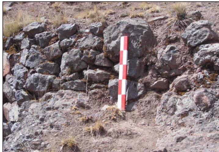
Foto N° 80: Aparejo simple de arenisca en el Muro de contención 02. Fuente: (Rado Aguilar & Espinoza Cruz)
