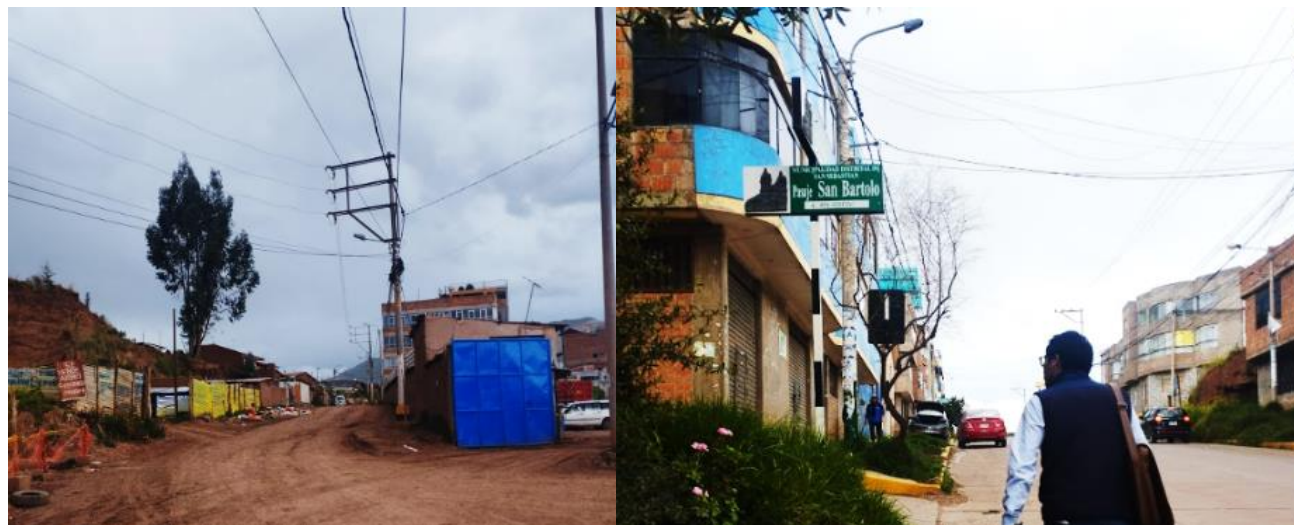
Figura 59 Cableado del Ámbito de Intervención
