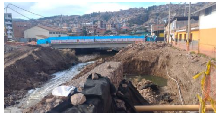
Figura 57 conexiones de desagüe al río Huatanay
