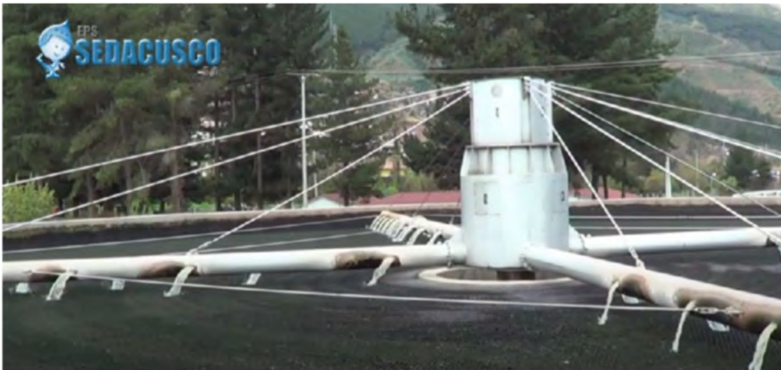
Figura 2. Tratamiento secundario de la PTAR Seda Cusco. Fuente: tomado de Sedacusco.
