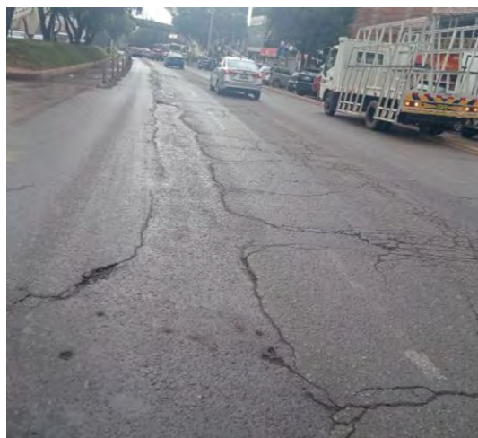
Grietas de bloque de severidad media (M), con fisuración moderada en forma de
