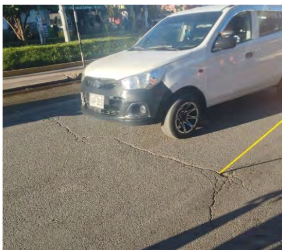
Fisura transversal de severidad media (M) con abertura moderada en pavimento
