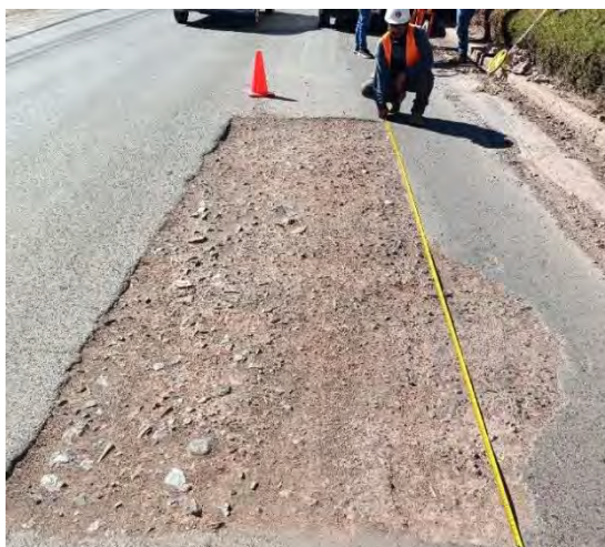
Parqueo longitudinal de severidad media (M) con deterioro superficial en Pav. Flexible
