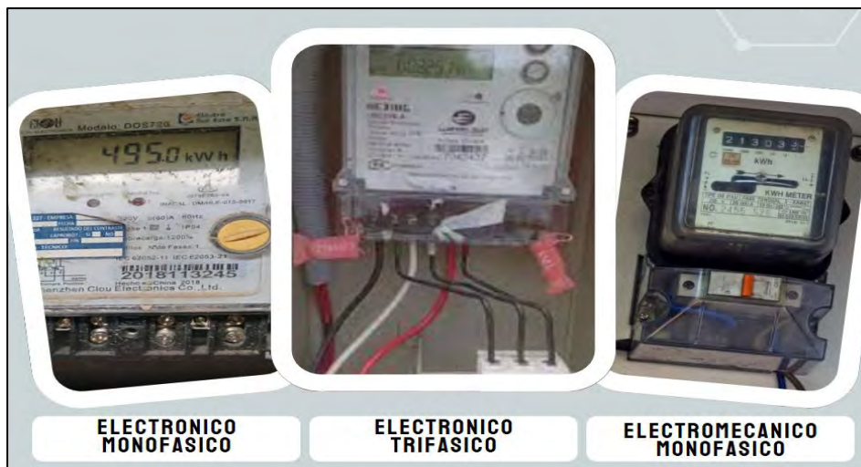
Figura 7 Tipos de Medidores Eléctricos Utilizados
