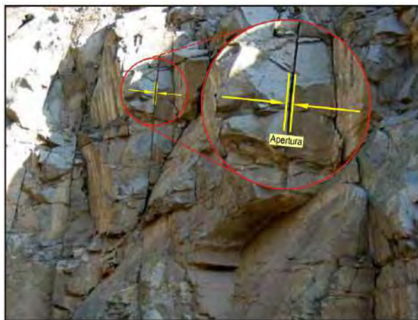
ILUSTRACIÓN N°2. Apertura de una discontinuidad.
