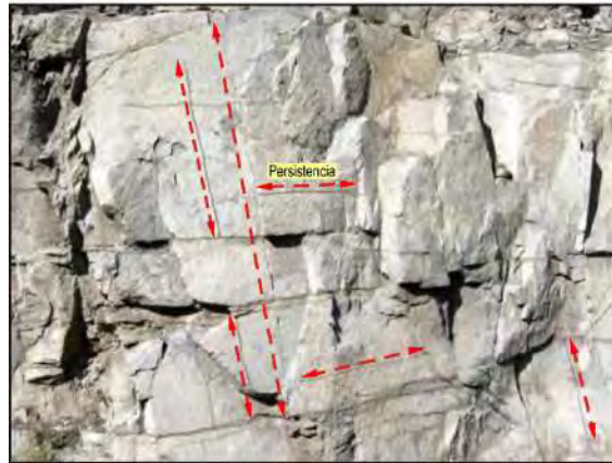
ILUSTRACIÓN N°1. Persistencia de las discontinuidades.
