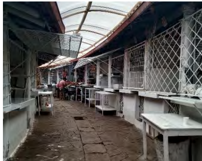
Figura N° 06: Infraestructura de puestos temporal e inadecuada Fuente: Propia (2020)
