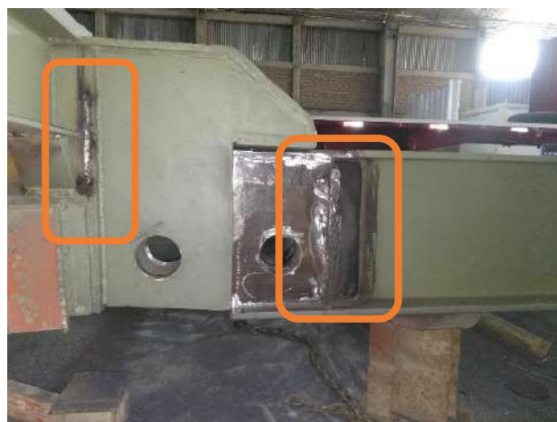
Figura 3.5: Fisura crítica por el cordón de soldadura en el soporte del cuello desmontable en un semirremolque cama cuna. (FUENTE: propia).
