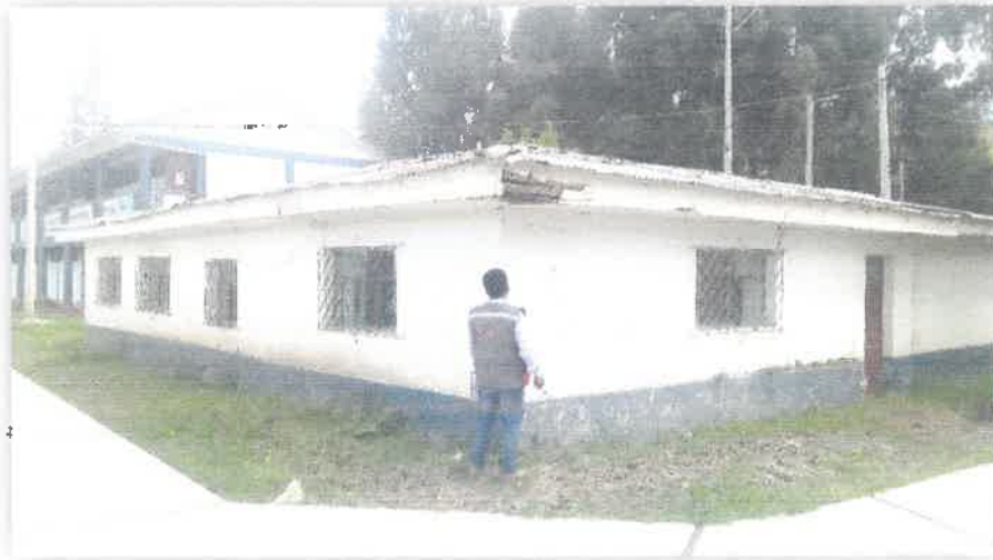
Fotografía 09.- el pabellón está prácticamente abandonado porque presenta daños en su estructural.
