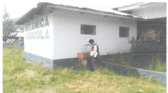
Fotografía 36.- las instalaciones de agua requieren mantenimiento general.
