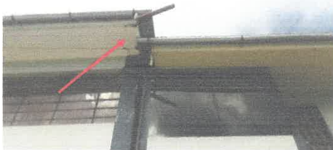
Fotografía 35.- las canaletas de evacuación pluvial no están conectadas hacia la red pública v/o alcantarillado.
