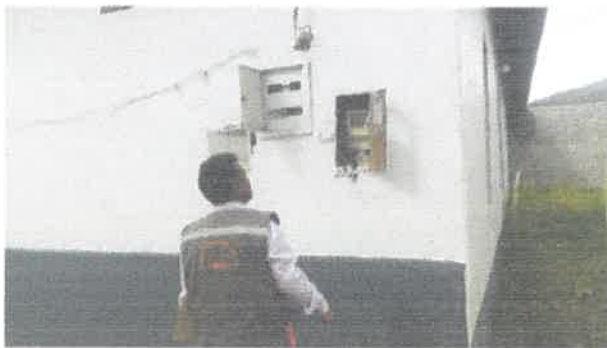
Fotografía 26.- el tablero de distribución en estado de abandono total en el auditorium.
