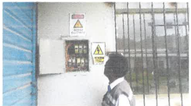
Fotografía 27.- el tablero de distribución requiere mantenimiento general que corresponde al pabellón de mecánica agrícola.
