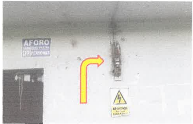
Fotografía 25.- la instalación de llaves de distribución en estado pésimo en el comedor central.
