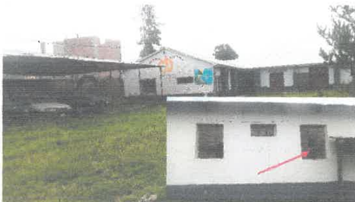
Fotografía 07.- pabellón de mecánica agrícola no se observa ninguna señalización y requiere mantenimiento.
