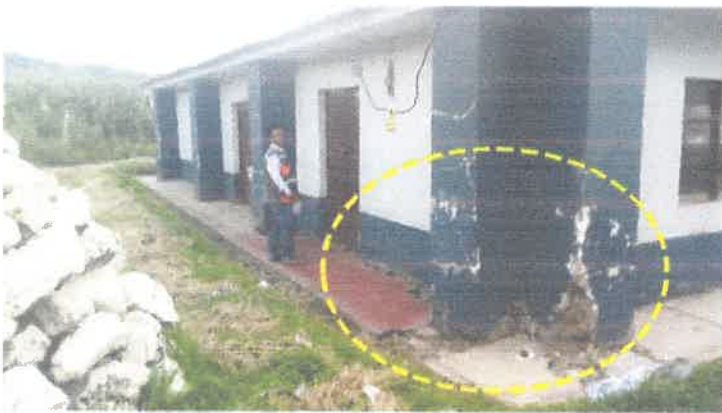
Fotografía 05.- el local de comedor esta deteriorado en la parte de la vereda, sobre cimentación.
