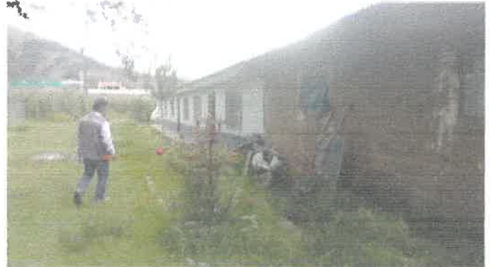
Fotografía 04.- se observa que los pabellones están en un completo estado de abandono requiere mantenimiento general.
