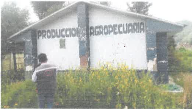
Fotografía 03.- el desgaste en la pared por falta de mantenimiento.
