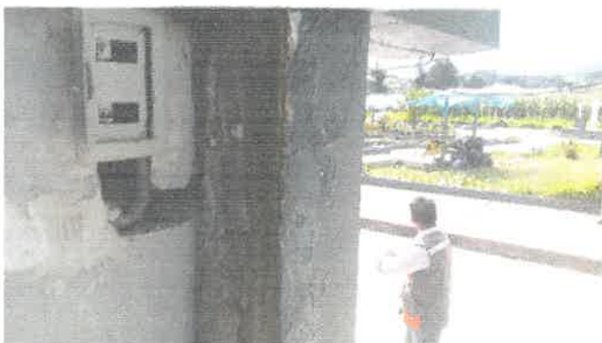
Fotografía 22.- el tablero de distribución en el bloque N° 03 requiere mantenimiento.
