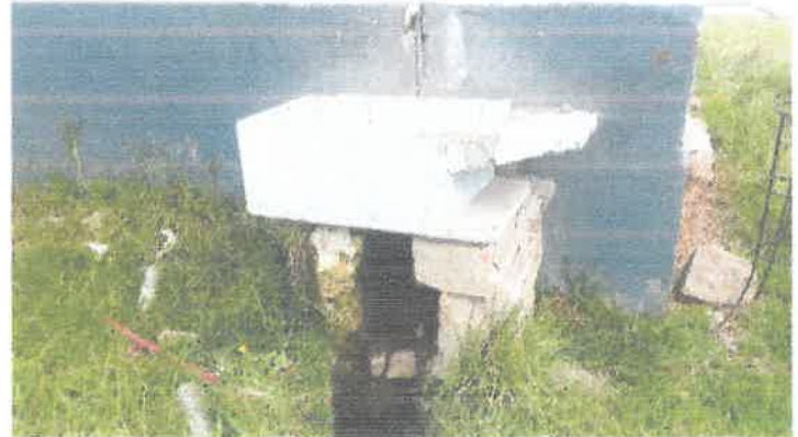
Fotografía 34.- el lavamanos y su instalación están en estado pésimo de conservación.
