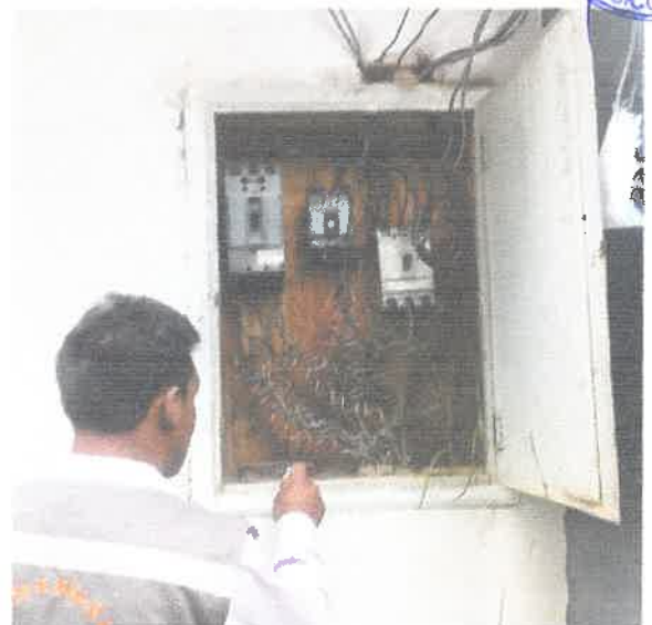
Fotografía 29.- el tablero requiere cambio total de acuerdo a las normas.
