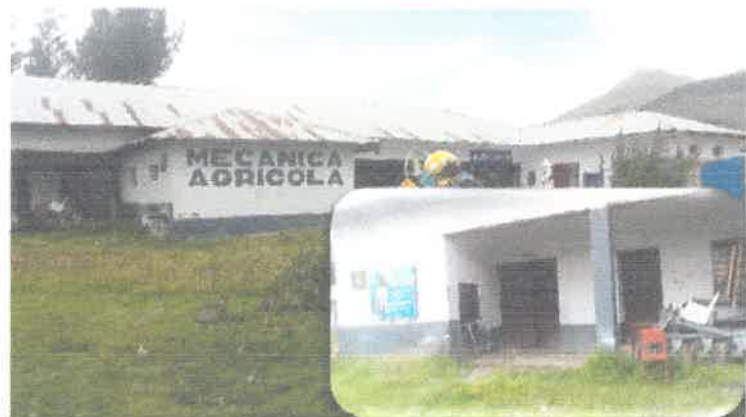
Fotografía 06.- se observa pabellón a falta de mantenimiento.
