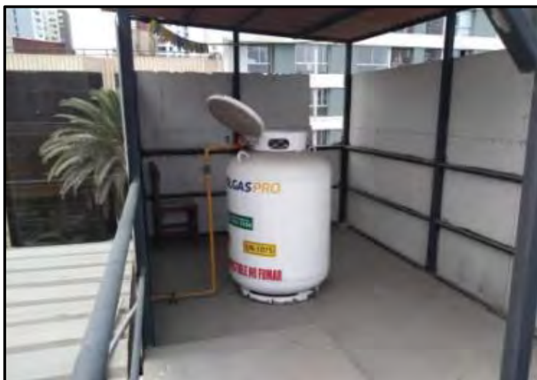
Tanque de GLP bajo techo
