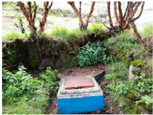
Figura 3 Cerco de protección captación Jilanaca Rancho
