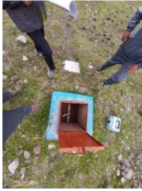
Figura 7 Cámara de purga del reservorio Colliri Grande
