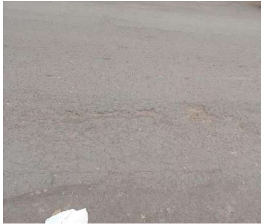
AV. Collasuyo (grietas y piel d)
