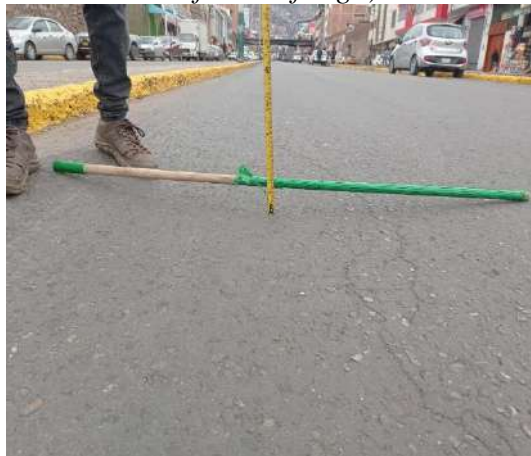
AV. Del Ejercito (abultamiento y hundimiento)
