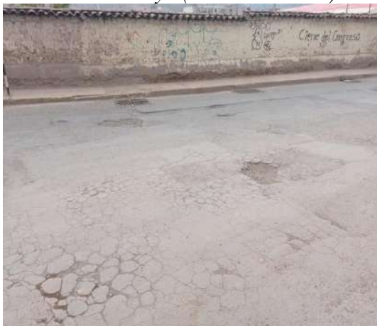
AV. Collasuyo (agrietamientos en bloque)
