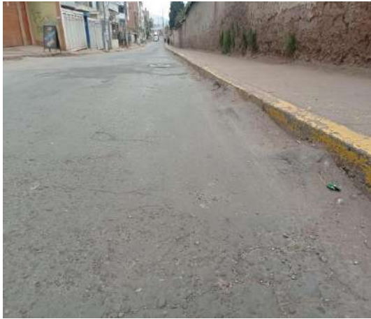
AV. Collasuyo (ahuellamientos)
