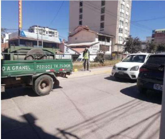
Vista frontal del operador del nivel de ingeniero en el primer tramo de la avenida Collasuyo -progresiva: 0+278 km
