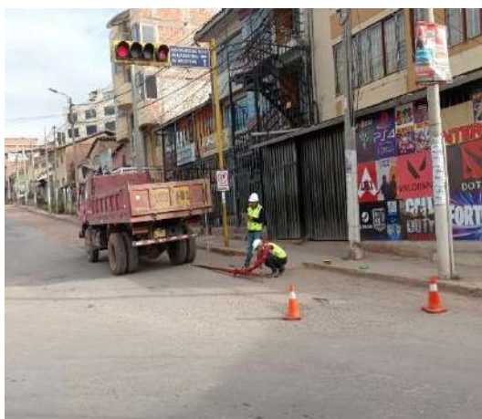
AV. Collasuyo (lectura tomada del deflectometro, al final de la vía 0.00 m)
