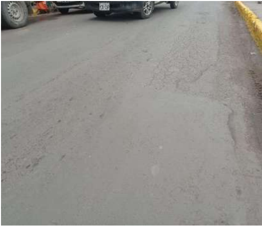
AV. Del Ejercito (grietas de borde)
