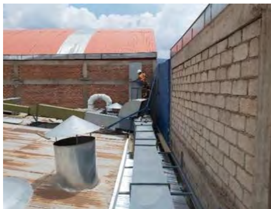
Fotografía 7 Instalación Final de recorrido del ducto de extracción de gases.
