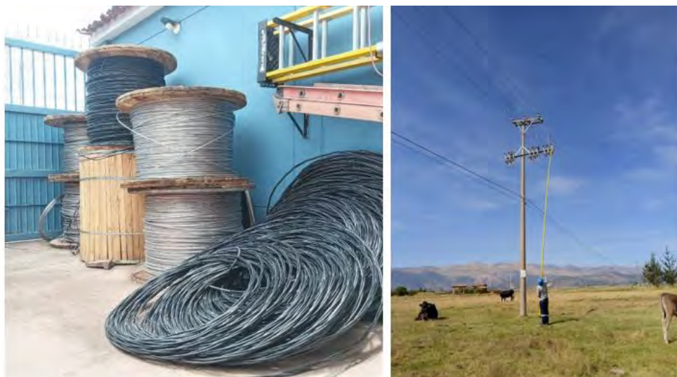
Figura 3. 3 Fotografías de carrete de conductores de MT e instalados en la Red del alimentador QU05.
