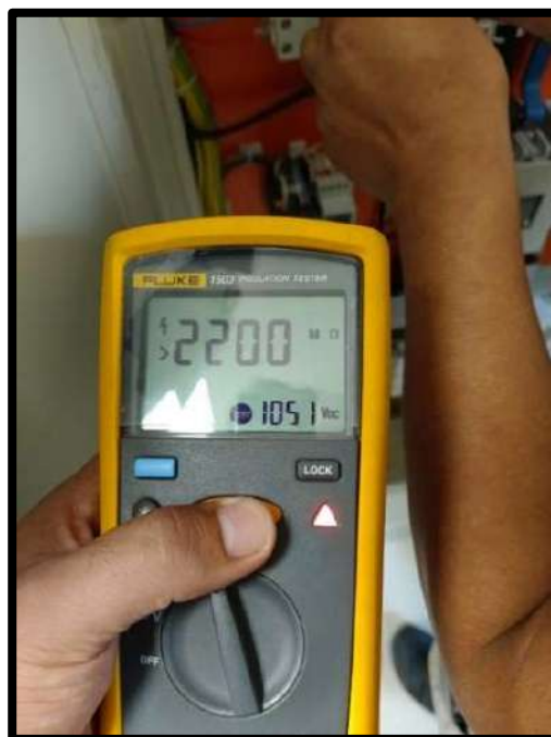
Figura 19 Pruebas de Aislamiento
