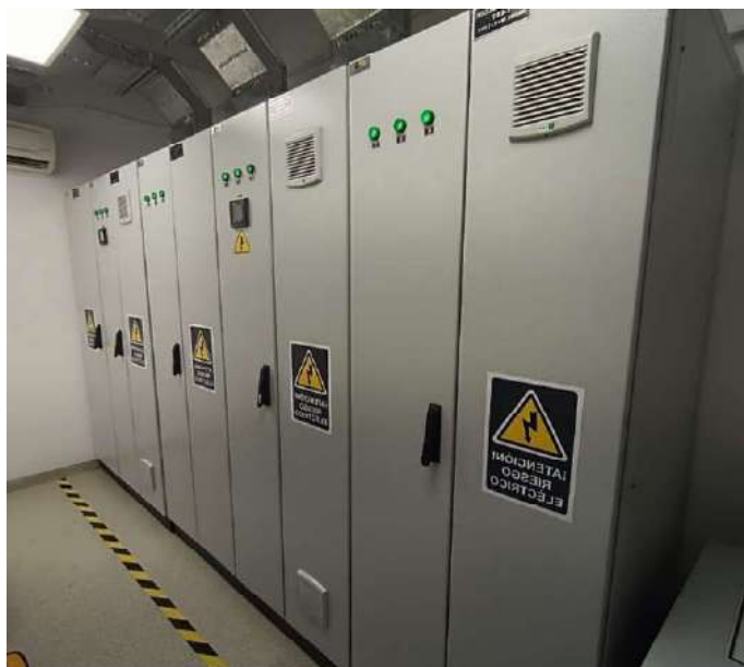
Figura 10 Cuarto Eléctrico – SODIMAC – Jockey Plaza
