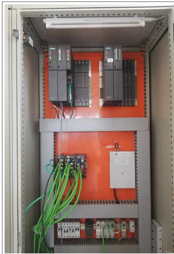
Figura 5.2: Tablero de control con PLC S7-400 y S7-416 para Braumat
