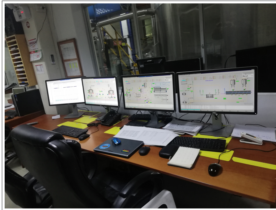
Figura 5.6: Centro de control de cocimiento con el sistema de control braumat
