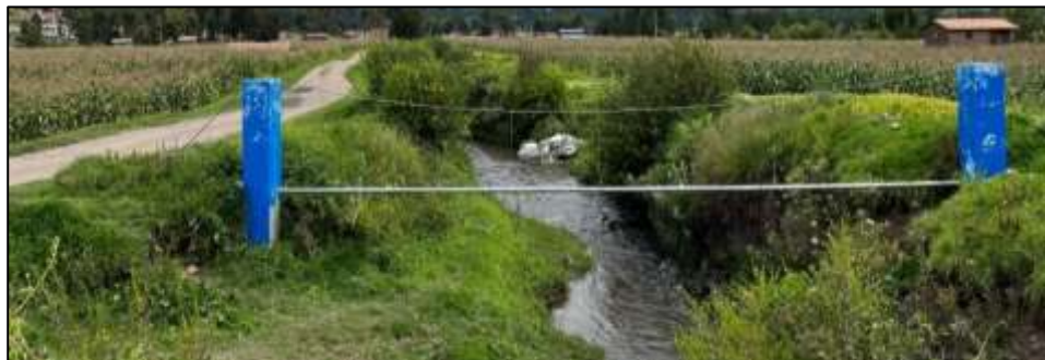
Foto 46: pase aéreo de línea de conducción principal expuesta a peligro de máxima avenida.
