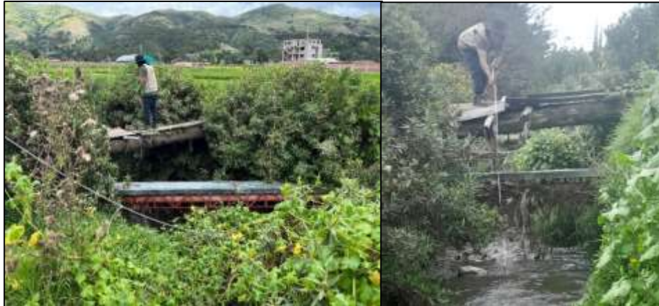
Foto 47-48: Línea de conducción principal de desagüe 6”, que atraviesa el curso del río Conchacalla en pase aéreo de baja altitud.
