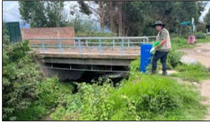
Foto 44: Pases aéreos de líneas de conducción de agua potable cerca a puentes a 1.40 m de altura del nivel del río.
