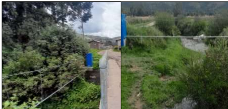
Fotos 45: pases aéreos de líneas de conducción principal expuestas a peligro de máximas avenidas.
