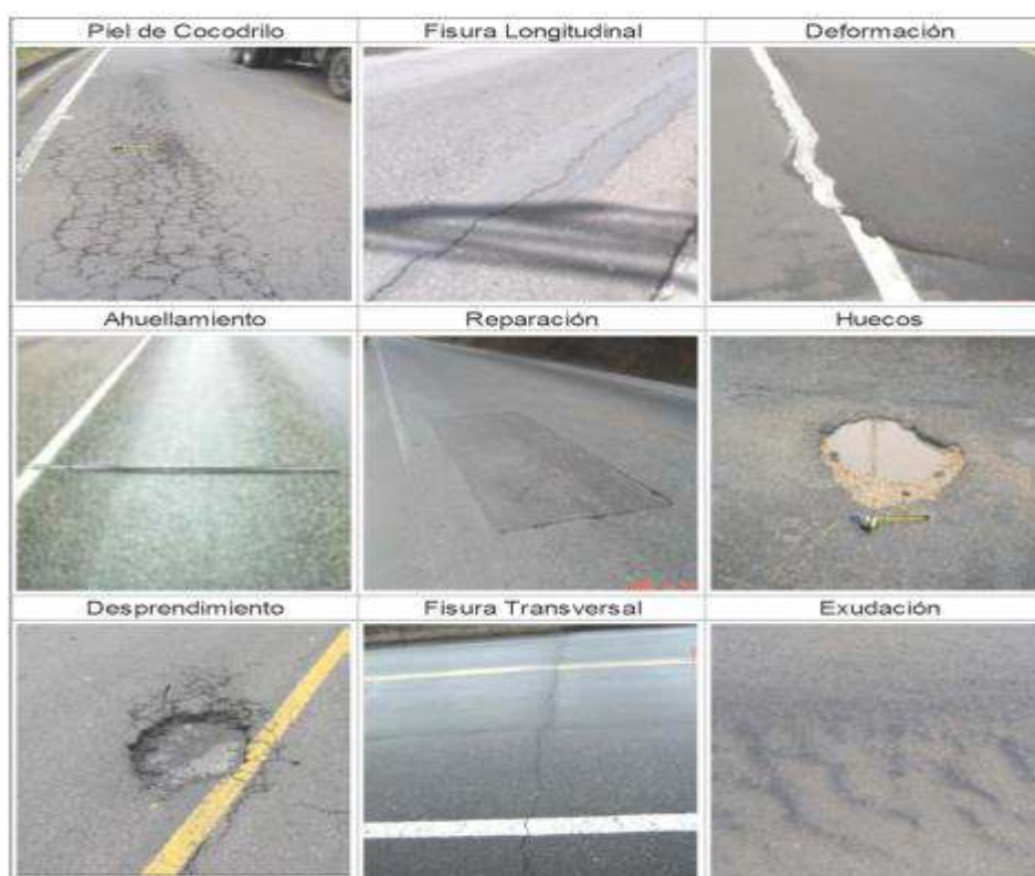
Ilustración 3: Daños en el Pavimento Flexible
