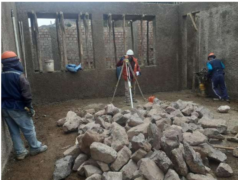
Figura 82 Nivelación de asentado de muros em referencia al nivel de piso terminado.
