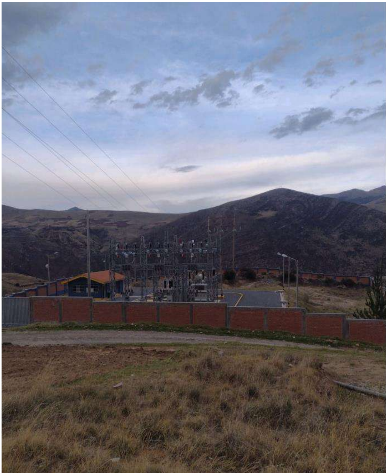
SUBESTACIÓN DE TRANSFORMACIÓN DE LLUSCO
