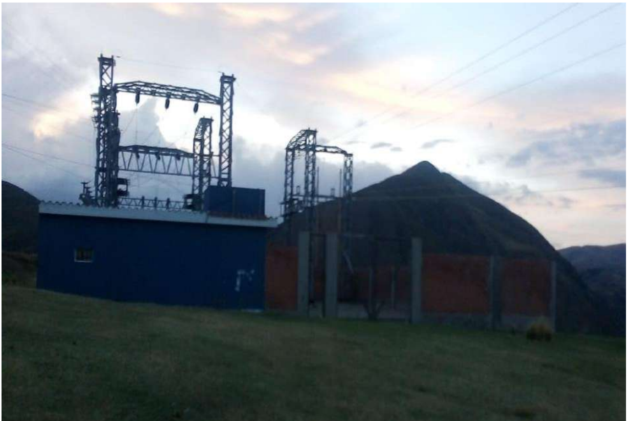
SUBESTACIÓN DE TRANSFORMACIÓN DE CHAMACA
