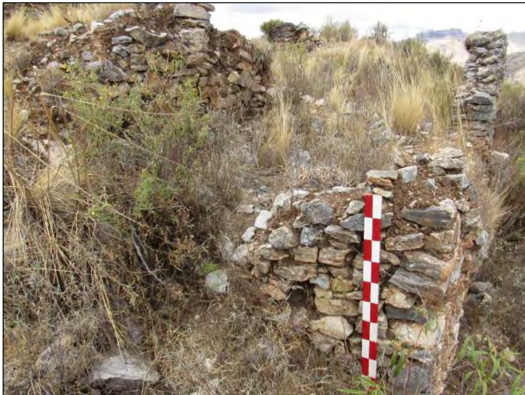
VISTA DEL LADO EXTERIOR RECINTO N° 05, NOTESE EL MAL ESTADO DE CONSERVACION
