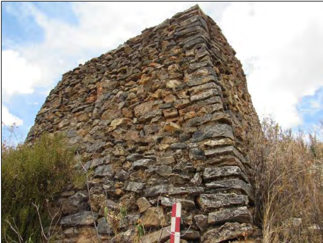
VISTA A DETALLE DEL MURO EXTERIOR DEL RECINTO, LA CIMENTACION TAMBIEN CUMPLE LA FUNCION DE MURO CONTENCION.
