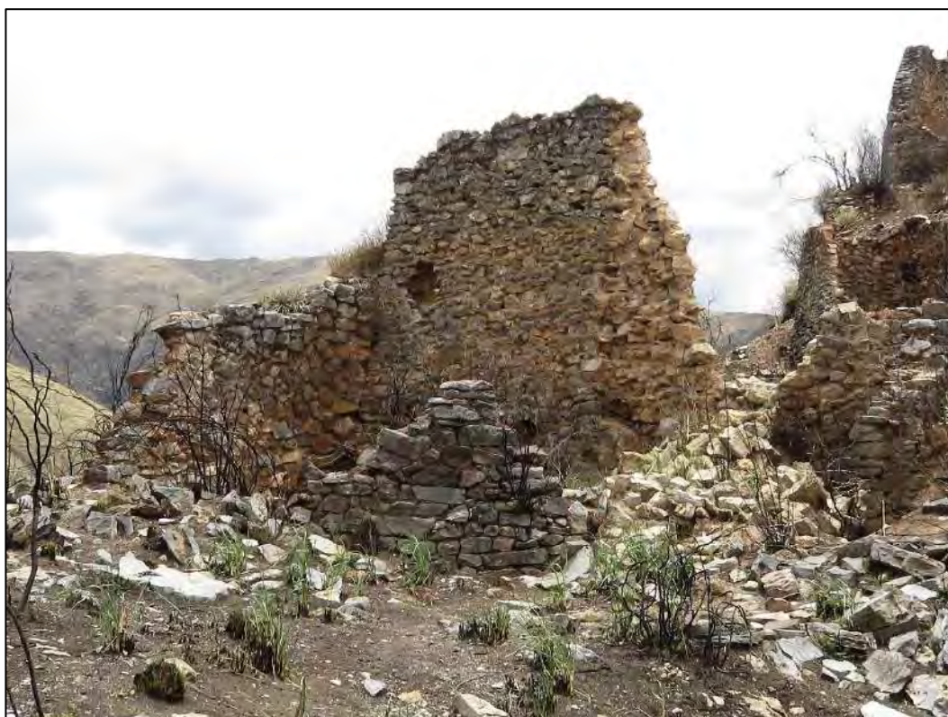
VISTA DEL RECINTO N° 10. NOTESE EL MAL ESTADO DE CONSERVACIÓN
