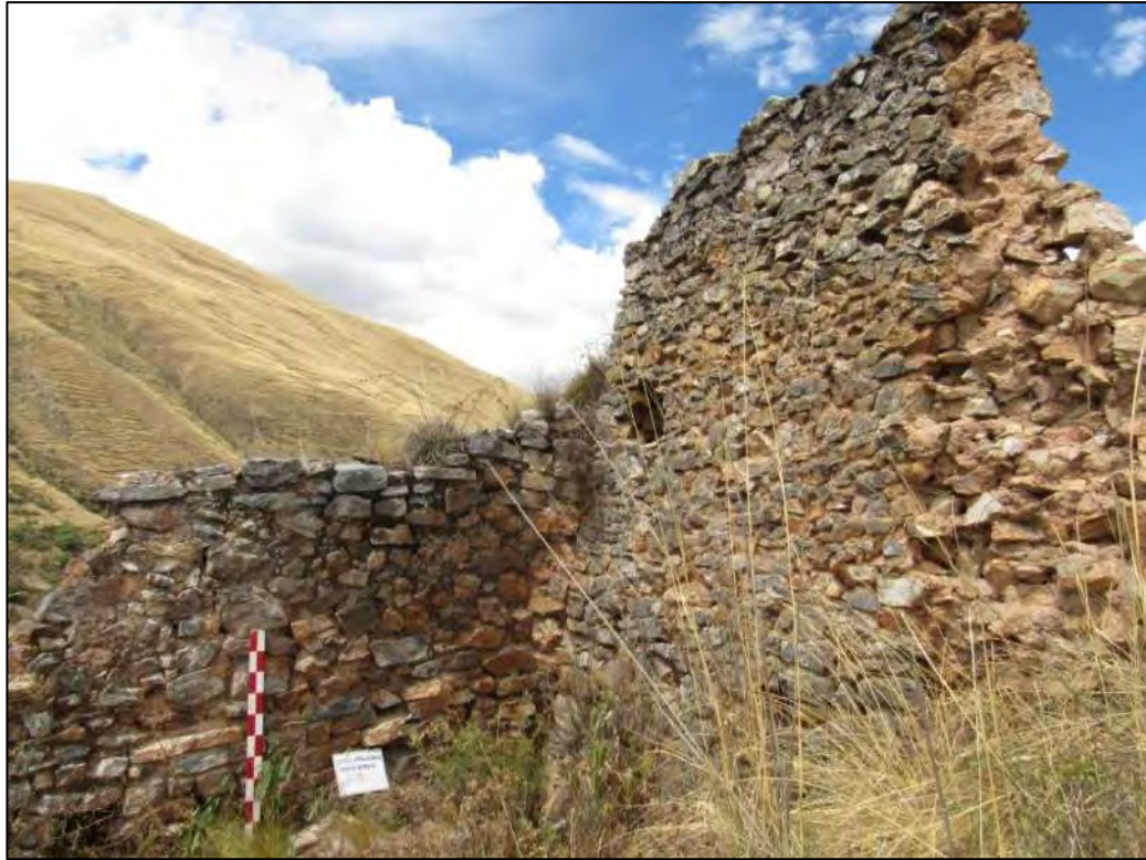
VISTA A DETALLE DE LA UNION INTERNA DE LOS MUROS, NOTESE QUE NO HAY UN AMARRE DE UNION.
