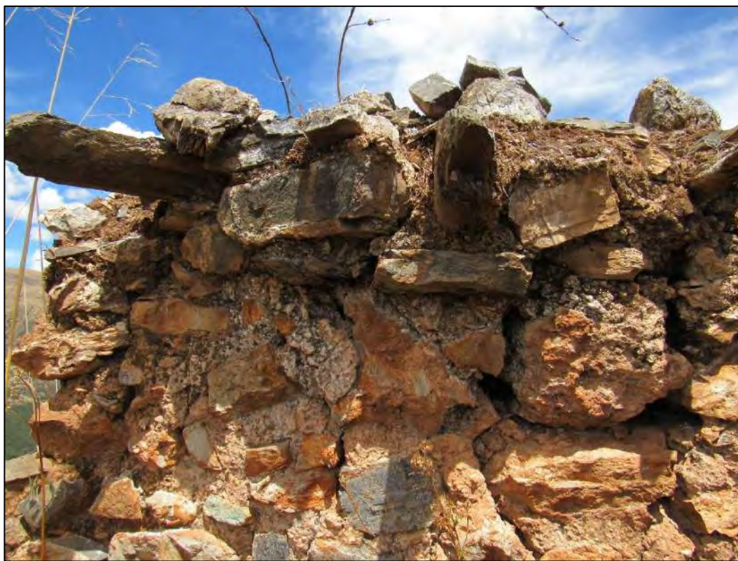
VISTA A DETALLE DE LAS LAJAS UBICADOS EN LA PARTE SUPERIOR DEL RECINTO.
