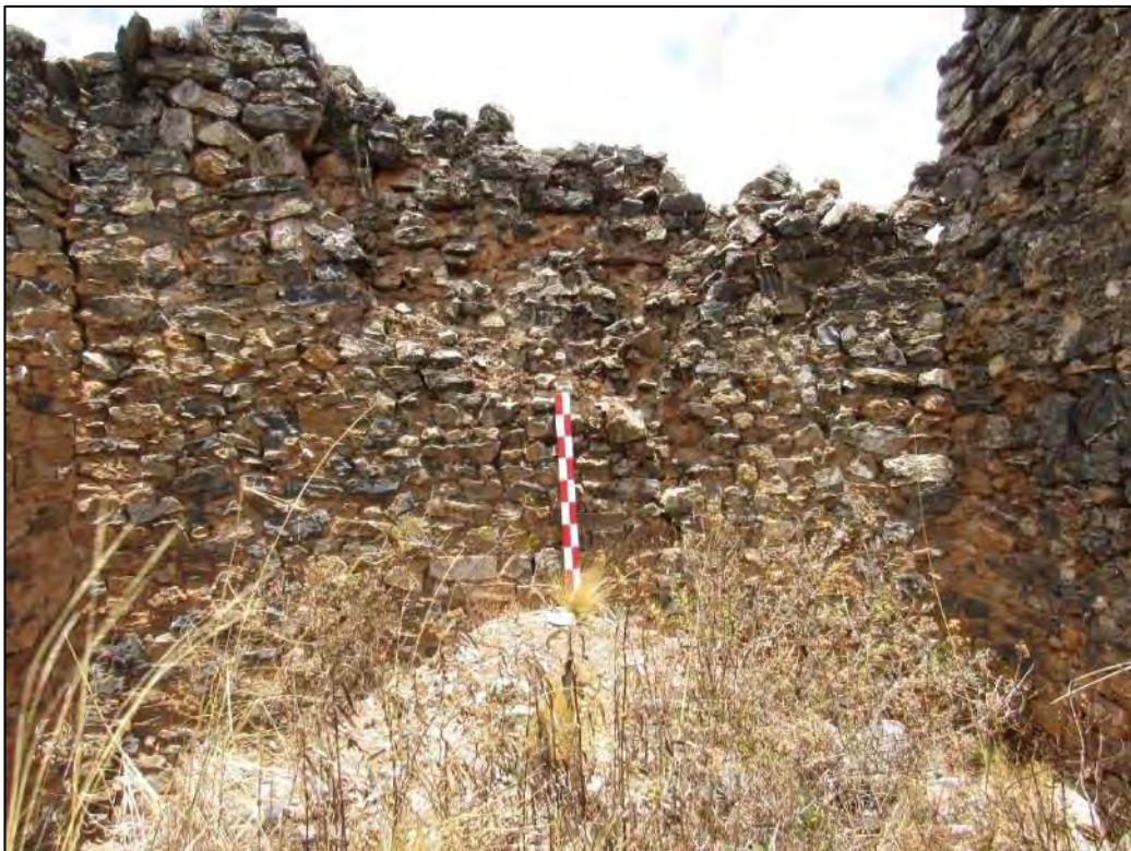
VISTA DEL MURO POSTERIOR PARTE INTERNA DEL RECINTO, NOTESE EL MAL ESTADO DE CONSERVACION.
