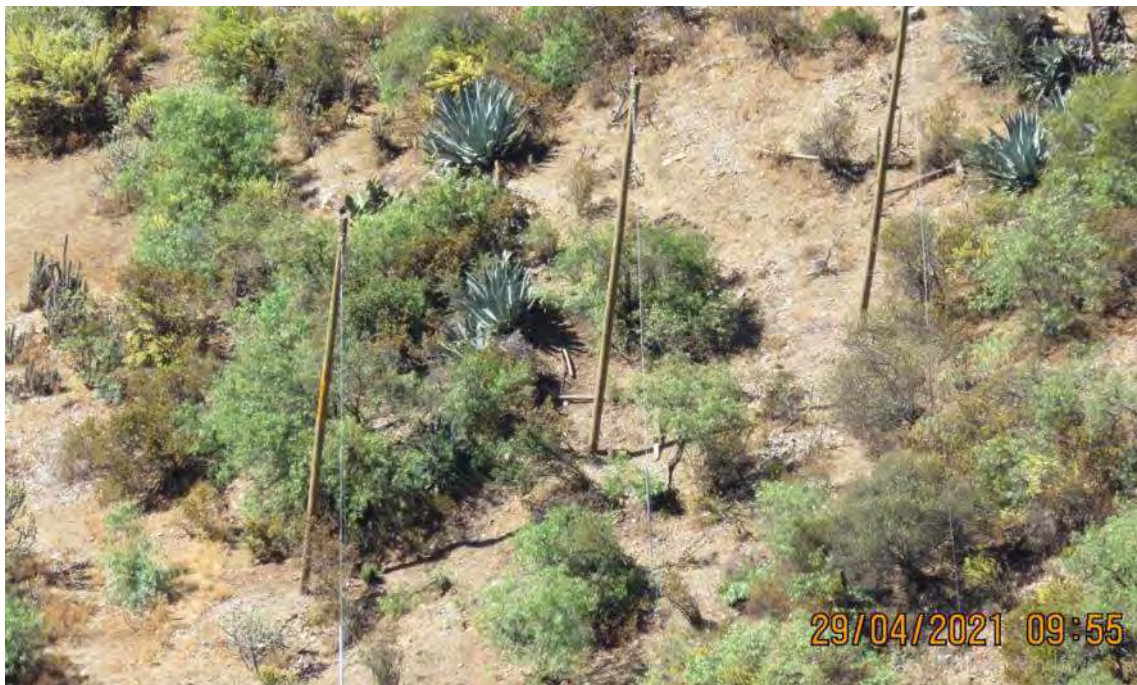
Fotografía 1. Triposte instalado en Sector Antabamba
