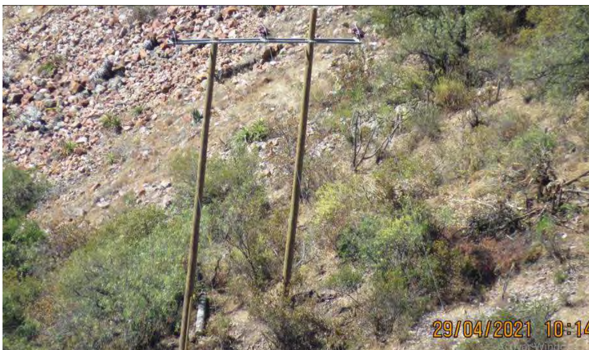
Fotografía 4. Estructura bifasica tipo H
