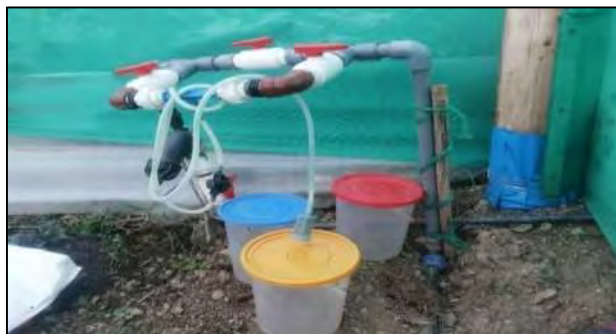
Figura 27. Inyección de nutrientes mediante el inyector venturi
