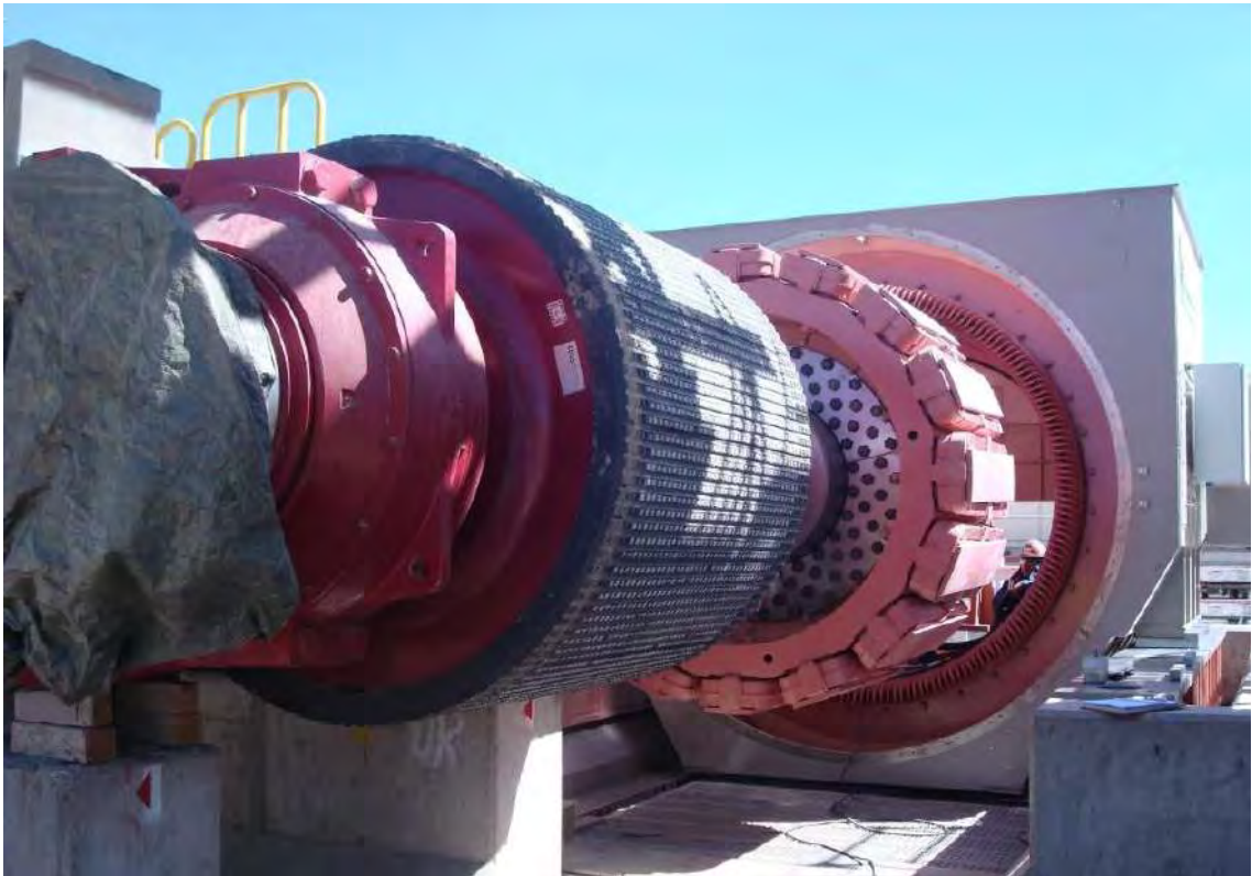
Figura 28. Motor síncrono acoplado a la polea motriz de una faja de 7 km.
