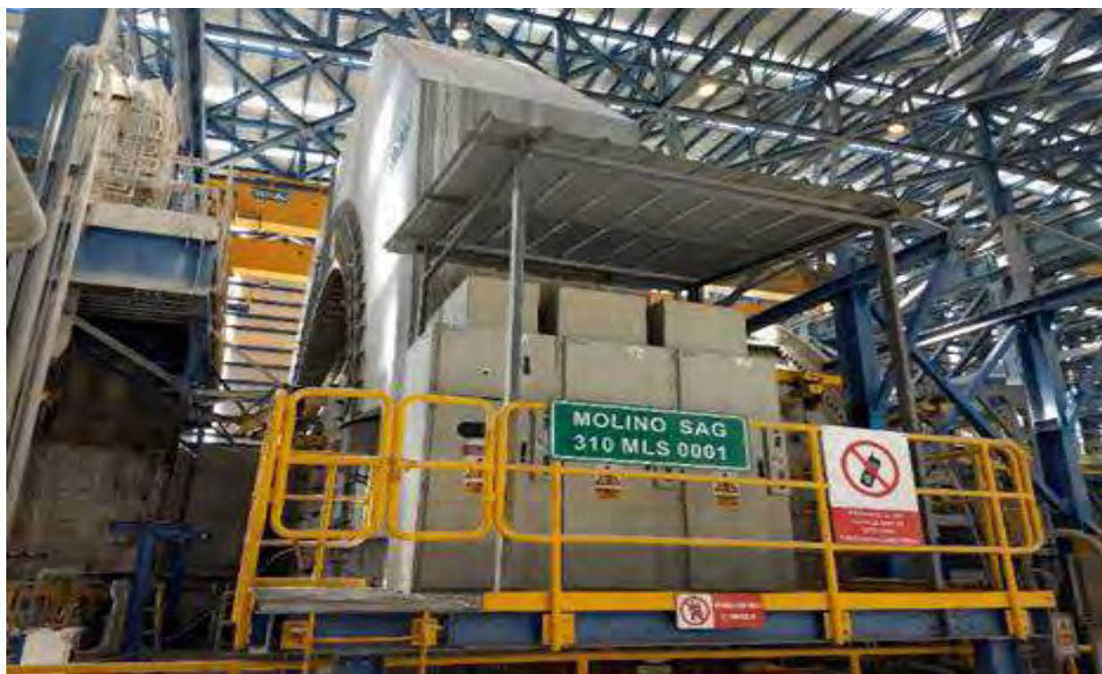
Figura 34. Cajas de seccionadores del motor anillo – Molino Sag.
