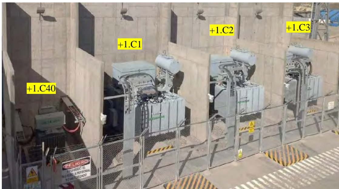
Figura 22. Patio de transformadores del molino Sag
