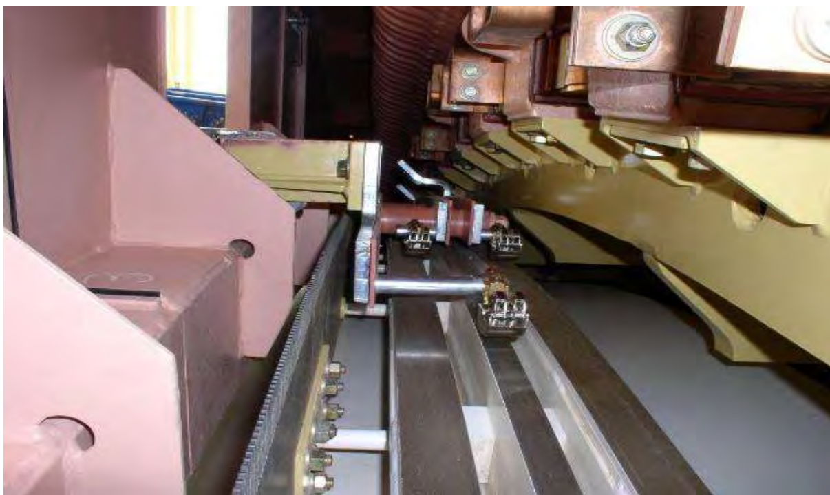
Figura 33. Sistema de anillos rozantes montados sobre el rotor – molino Sag.
