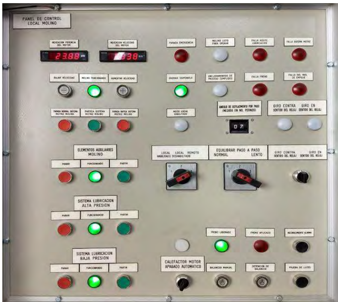
Figura 26. Tablero de Control Local Molino Sag.
