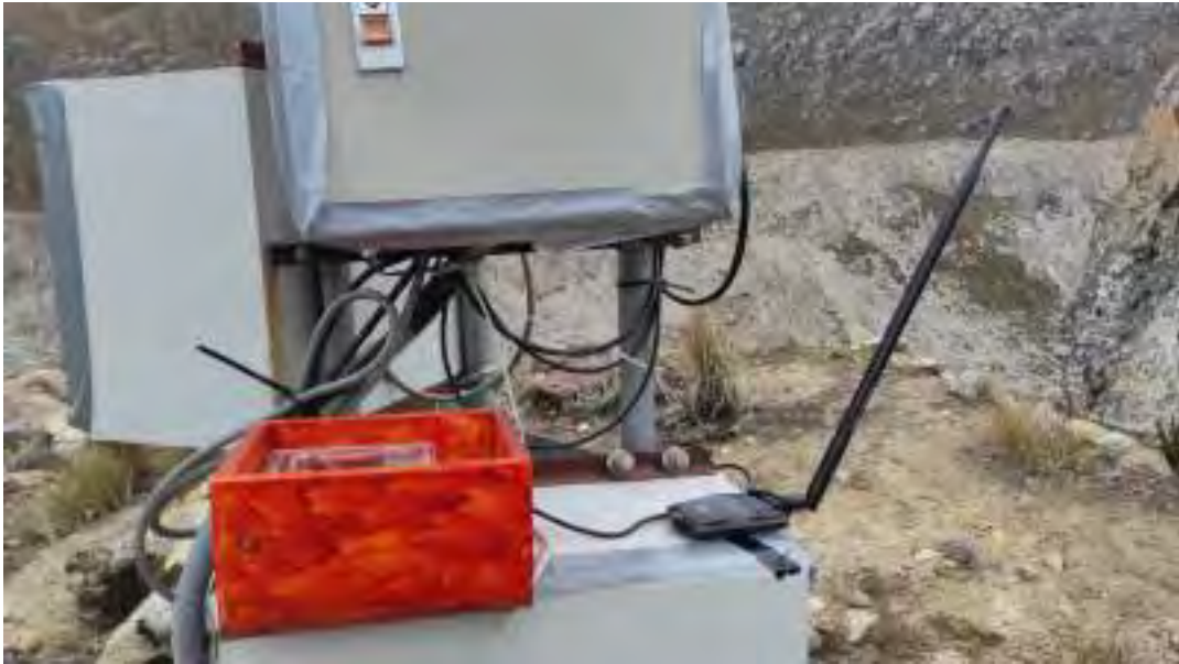
Figura 65: Instalación del sensor con el módulo externo de WiFi.
