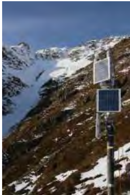
Figura 4: Sistema de detección y monitoreo de avalanchas instalado por Geopraevent alrededor de la montaña Piz Chapisun en el valle de Lower Engadin (Suiza).
