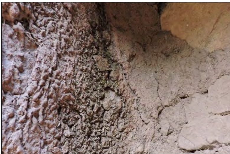
Figura 55. Presencia de revoque en muro interior del recinto R-7
