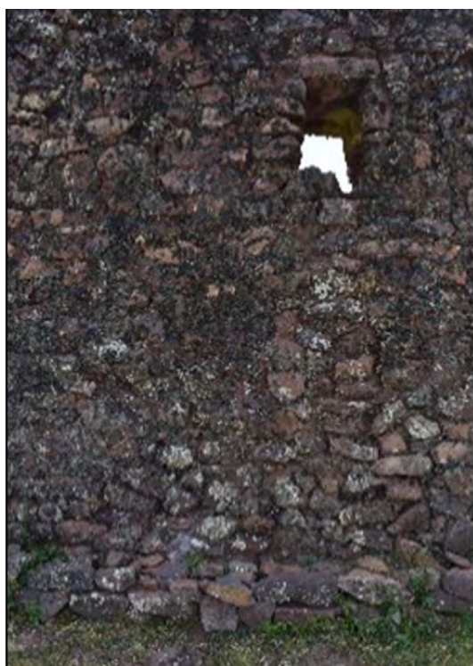
Figura 58. Muro externo sur, R-7.
