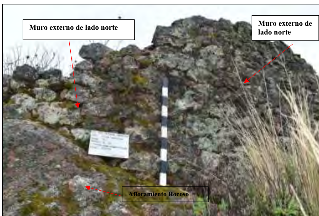
Figura 160: Evidencia de afloramiento rocoso en la base de muro.
