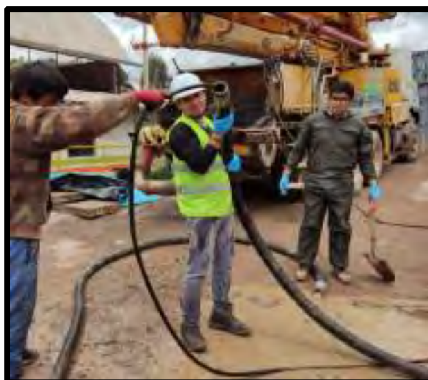
Figura 29. Tuberías para transporte de material de 2”
