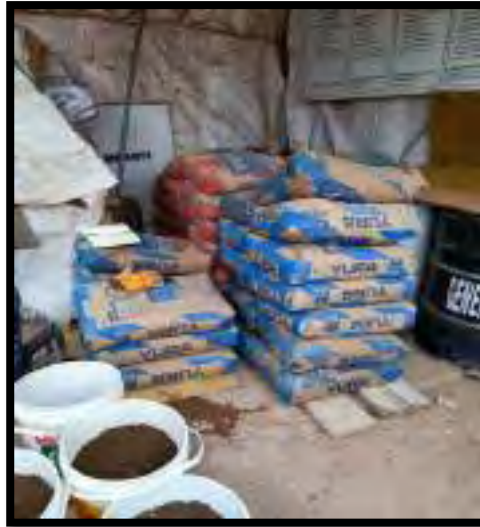
Figura 106. Apilamiento de los cementos IP y HE.
