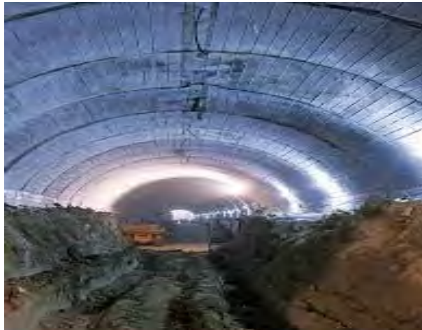
Figura 8. Juntas de construcción en estabilización en minería.
