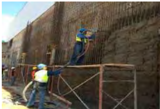
Figura 6. Proyección sobre superficie de concreto y acero.
