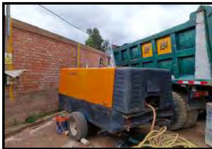
Figura 112. Compresora de aire CompAir.
