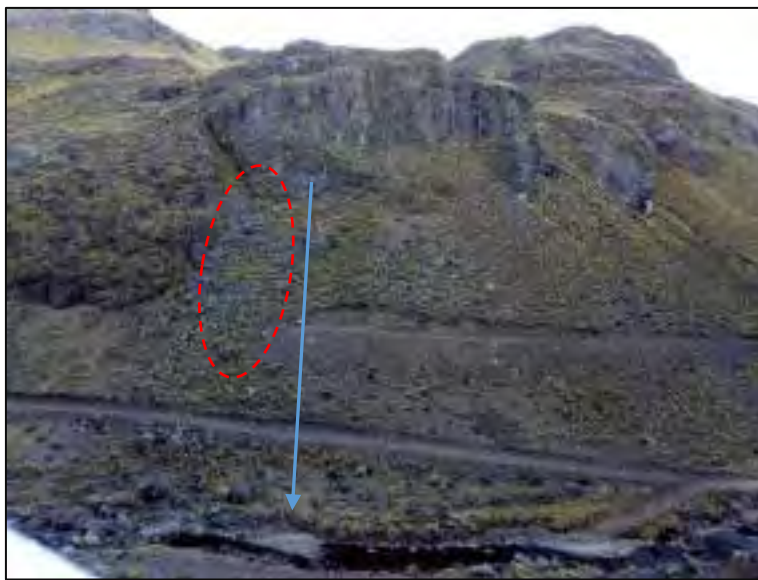
Foto N°6.3: Identificación de zonas de derrumbe de roca en la margen derecha del vaso.
