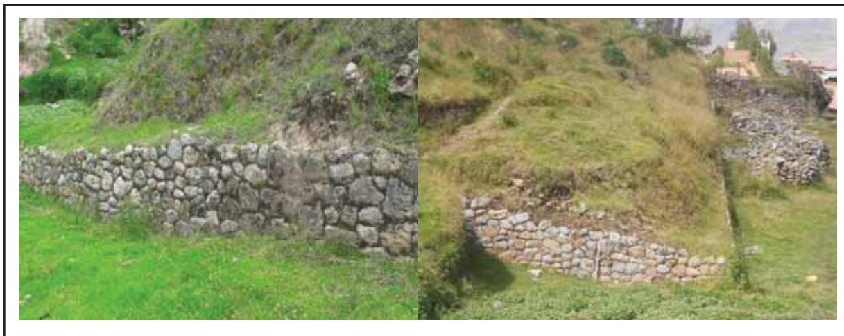
Figura 48. Se observa el desplazamiento del muro de contención antecediendo a las estructuras rectangulares del sector B
