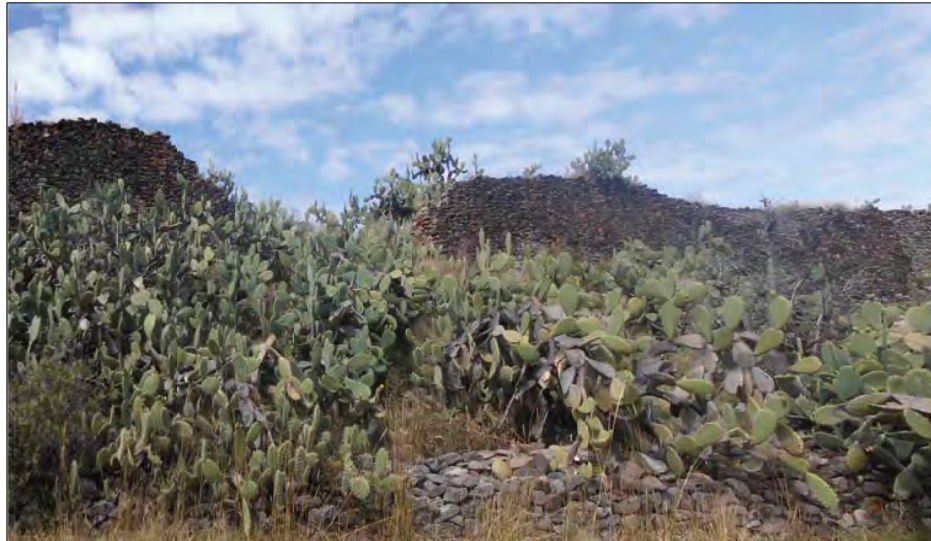
Foto de colapso en muro
