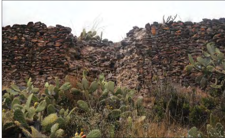
Foto de pre-colapso en muro
