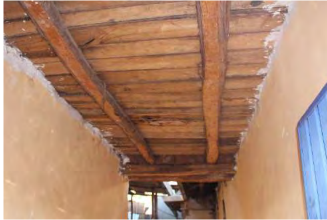
Figura 4.10 Edificación de dos pisos con diafragma irregular y falta de rigidez, no presenta viga solera. Fuente: Elaboración propia, 2019.
