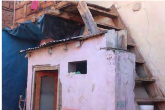
Figura 2.29. Escalera de vivienda, con claros signos de deterioro y agrietamientos. Con elementos mal vinculados a la estructura. Fuente: Elaboración propia, 2019.
