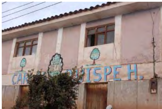
Figura 2.7 Vista de una de las viviendas estudiadas, donde se evidencia la presencia de grietas mayores a 3 mm. Fuente: Elaboración propia, 2019.
