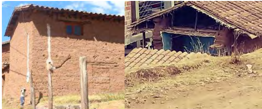
Figura 4.17 Se observa la configuración de par con viga cumbreira. Fuente: Elaboración propia, 2019.
