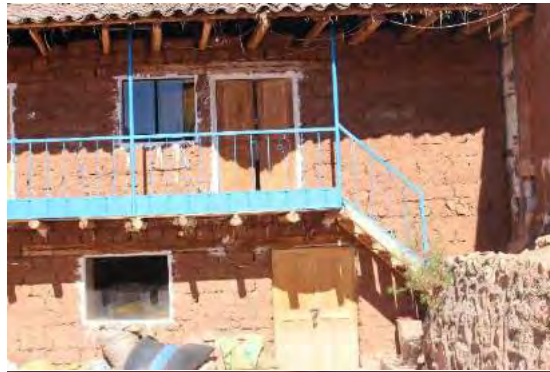
Figura 4.5. Homogeneidad de las piezas y presencia de trabazón entre las unidades de adobe en la vivienda encuestada n° 06. Fuente: Elaboración propia, 2019.
