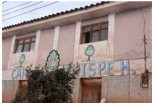
Figura 4.21 Se observa el mal estado de conservación de la edificación. Fuente: Elaboración propia, 2019.
