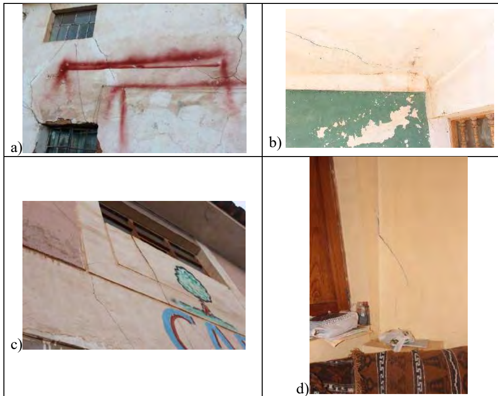
Figura 3.16. Fotografías de las grietas presentes en las viviendas encuestadas, a) Vivienda encuestada n° 01, donde se aprecian rajaduras en la fachada, b) Vivienda n° 04, donde se aprecian rajaduras en el alero principal, c) Vivienda encuestada n° 10, donde se aprecian rajaduras en gran parte de la fachada, d) Vivienda n° 13, donde se aprecian rajaduras en el interior de la vivienda, en el encuentro de muros.
