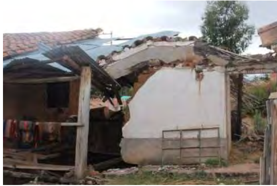
Figura 2.6 Vivienda destruida por efecto de deslizamientos en época de lluvias, dado que se encuentra en zona de alta susceptibilidad de movimiento en masa. Fuente: Elaboración propia, 2019.
