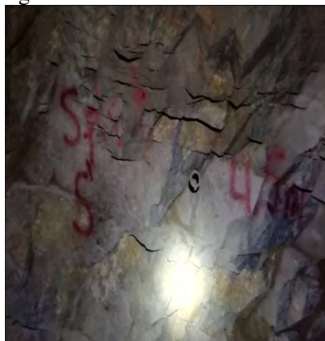
Fotografía N° 1 Falla en Perno de Anclaje
