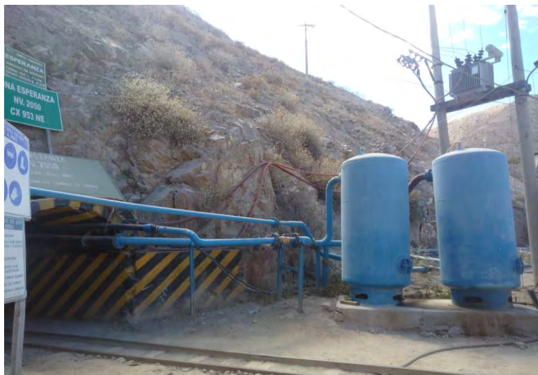
Figura 20: Tanques de aire comprimido.
