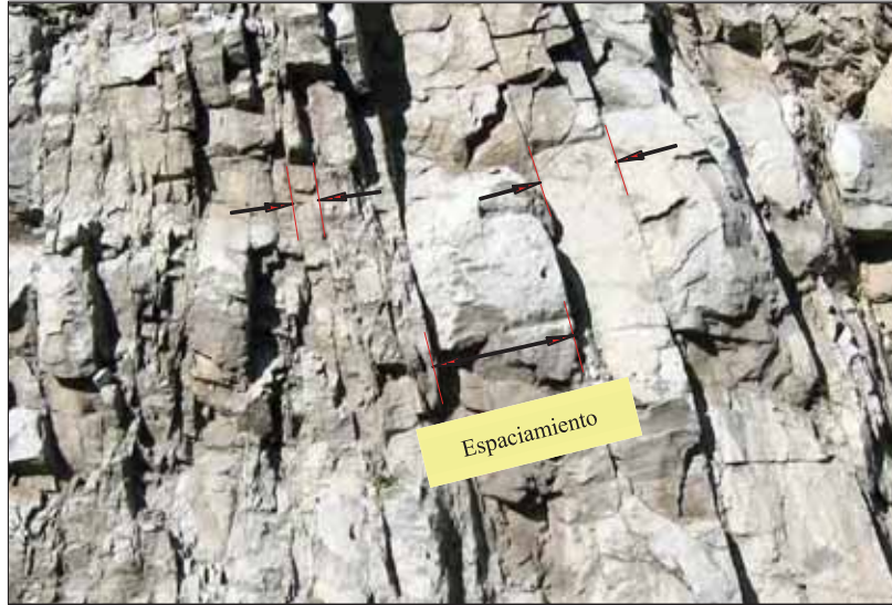
Fuente: Manual de Geomecánica, Conociendo a la roca. Figura N° 02. Espaciado de una discontinuidad.
