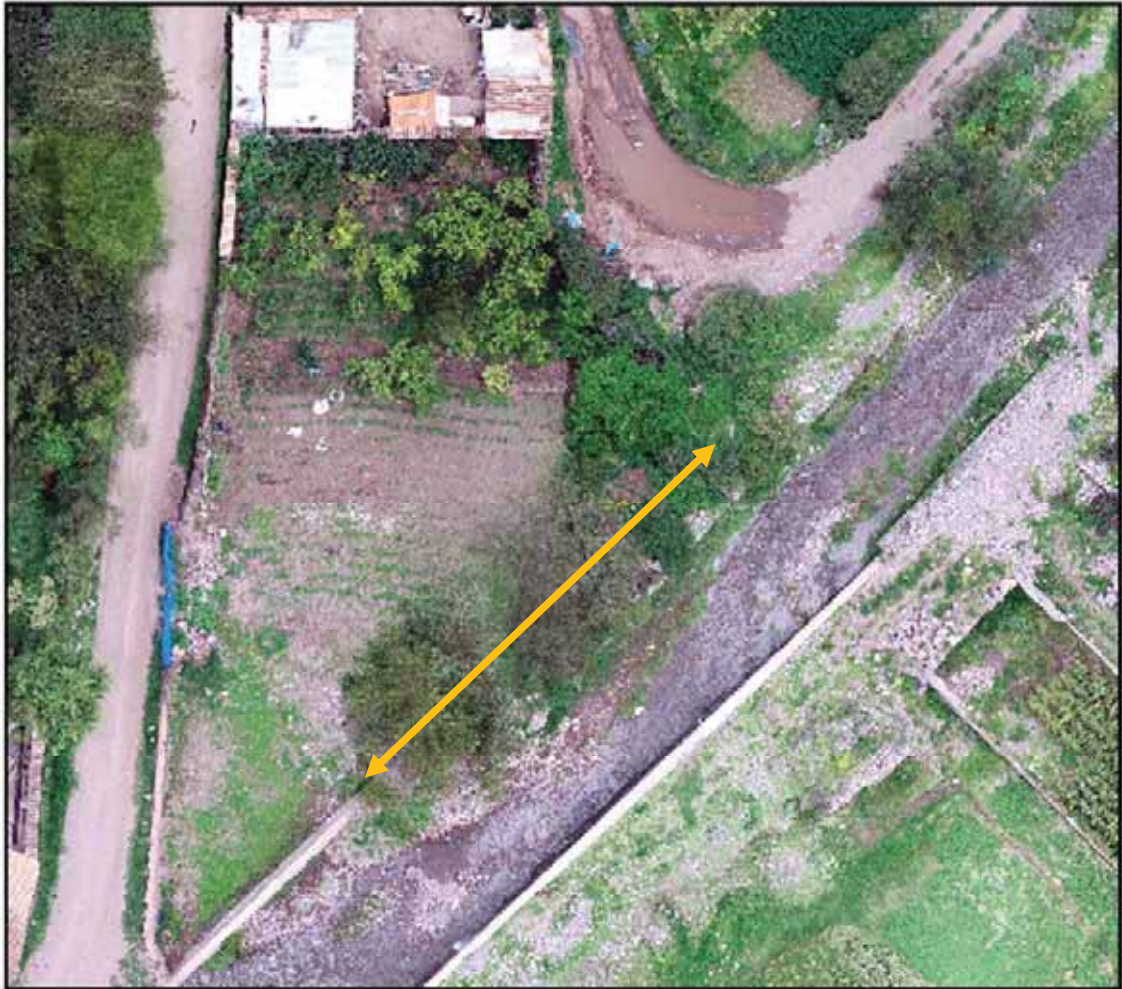
FOTOGRAFIA N°2. 7 VISTA DEL TRAMO FALTANTE DE DEFENSA.
