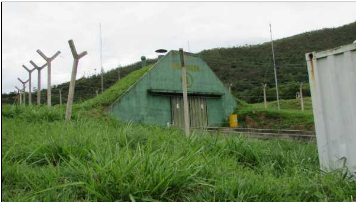
CERCO DE ALAMBRE PUADO EN MAL ESTADO – ROTO EN DIFERENTES PARTES
