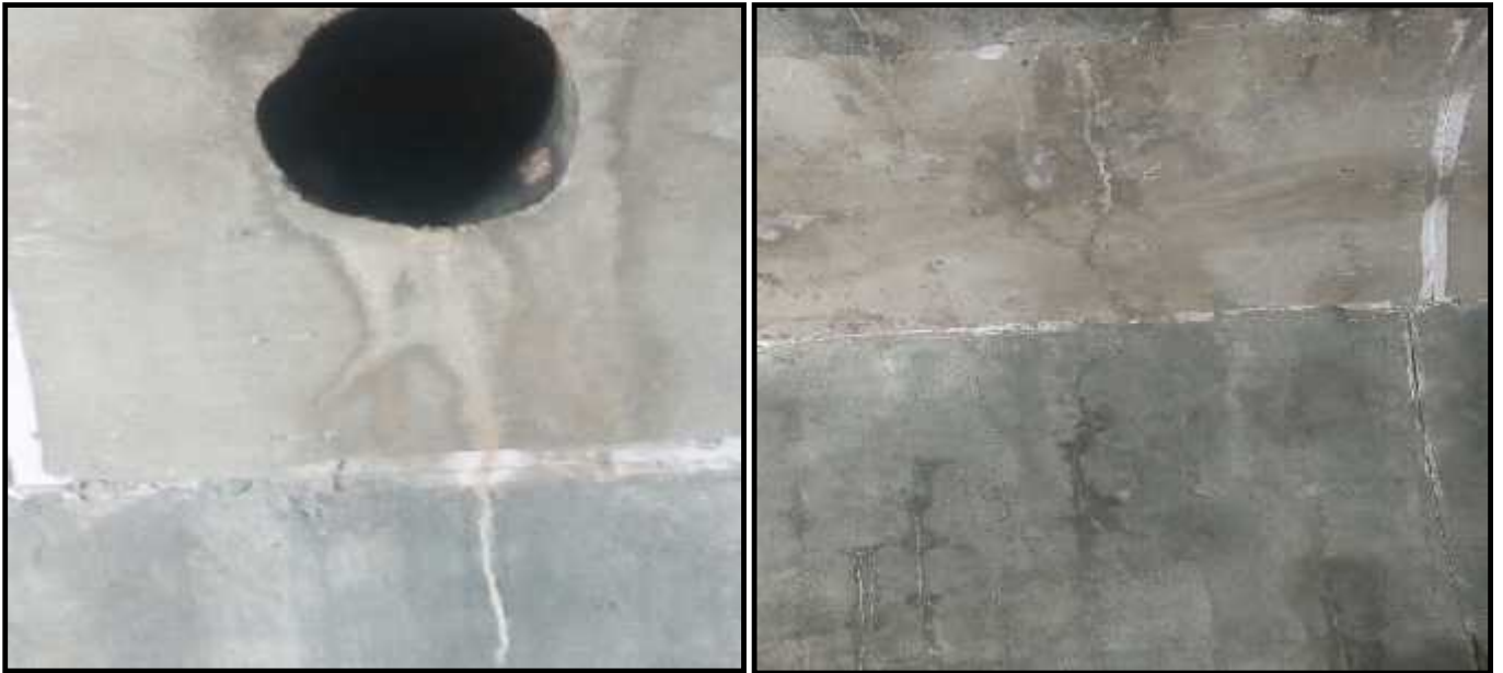
TECHOS Y PAREDES RAJADAS CON FILTRACIONES
