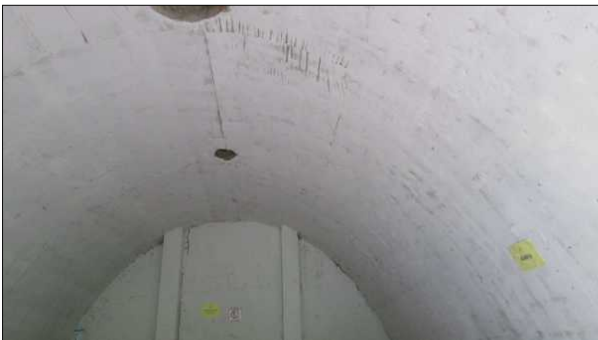
INTERIOR DEL ALMACEN CON FISURAS EN EL TECHO Y DIFERENTES PARTES
