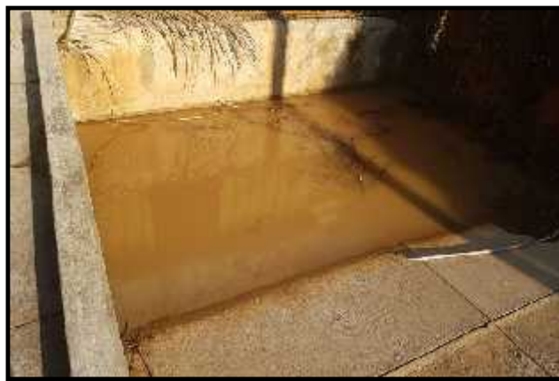
SISTEMA DE DRENAJA OBSTRUIDO – INUNDADO
