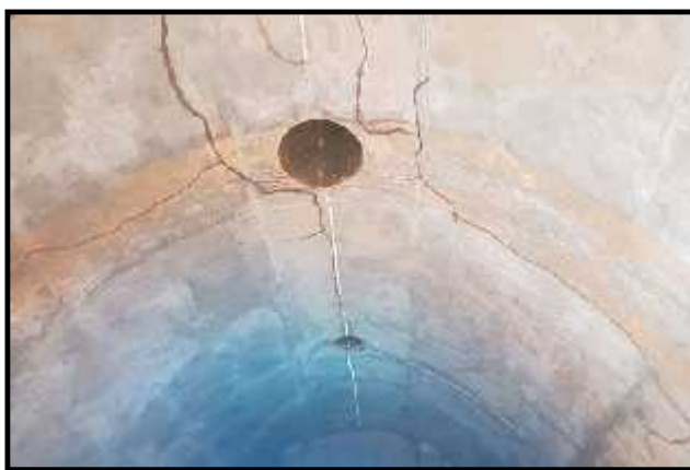
TECHO Y PAREDES RAJADAS, CON FILTRACIONES
