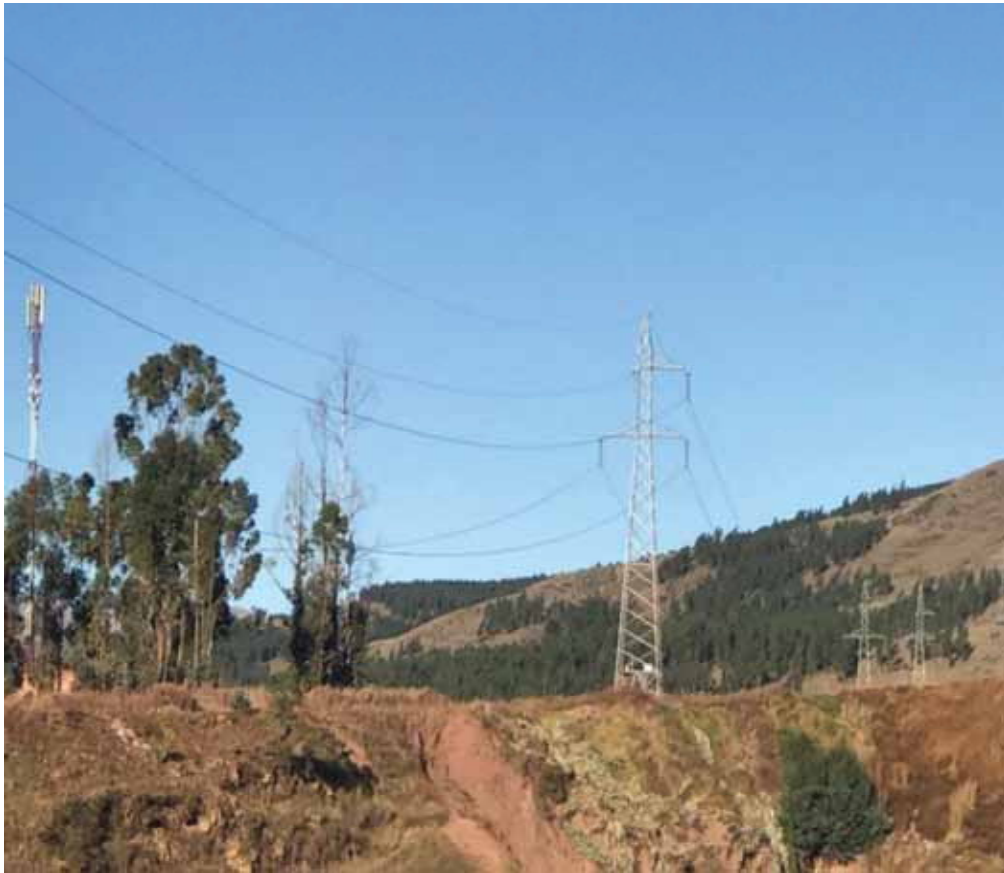
Foto 5:Foto de las torres de transmisión y las antenas de comunicación
