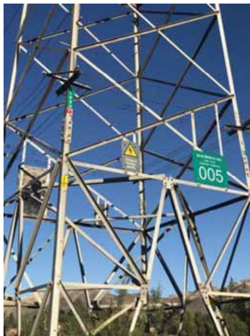
Foto 4:Foto que muestra la línea de transmisión 1050
