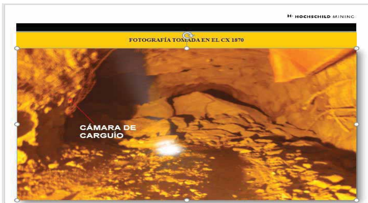
Figura 66: Desprendimiento de rocas CX 1870
